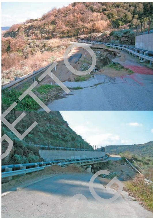
Fig. 77 - Punti di vista opposti del cedimento della sede stradale S.P. Ittiri-Banari a causa di una frana di scivolamento.
