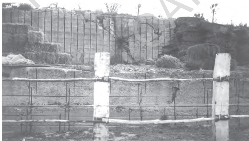
Fig. 15 - Passaggio verticale ai depositi clinostatificati e festonati dei cordoni sommitali (TNZ d ) del sintema di Terenzano. Maneggio di Masseria Cascione
