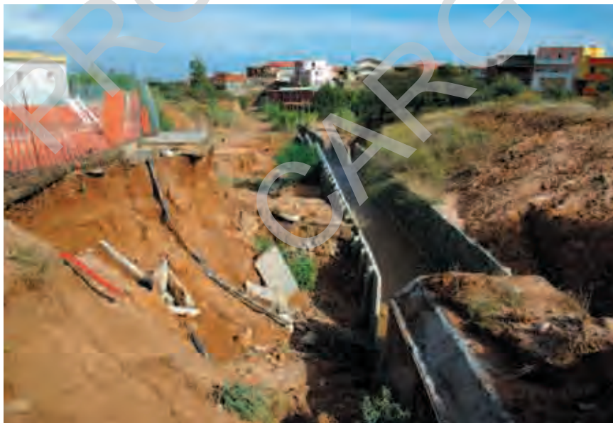
Fig. 75 - Intensi processi erosivi causati dall'evento di piena del 22 ottobre 2008 nei pressi della piscina comunale di Capoterra.
