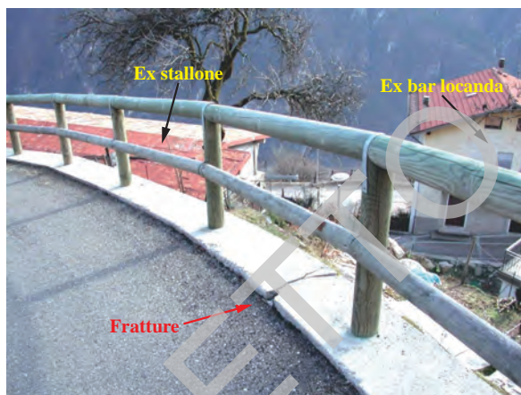
Fig. 102 - Panoramica ripresa da monte della porzione di versante compresa tra l'ex stallone e l'ex bar locanda, con in evidenza le fratture riconducibili al fenomeno franoso in atto.
