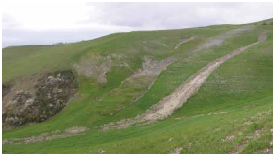
Figura 1.21 – Panoramica di un versante interessato da molteplici colamenti lenti. La presenza di litotipi prevalentemente argillosi, l'assenza di copertura arborea e arbustiva e di opere di regimentazione delle acque di ruscellamento hanno creato le condizioni favorevoli all'insorgere dei fenomeni di dissesto. Località Mazzolla, comune di Volterra (PI).
