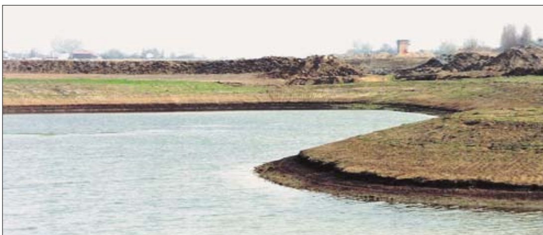
Problemi d'erosione in un'area umida possono avvenire per la natura particolare dei terreni, per la presenza di fetch troppo lunghi, per la pendenza troppo ripida delle sponde.
