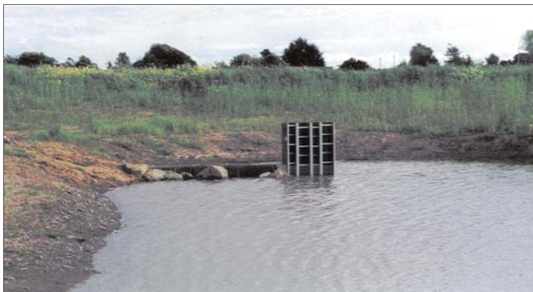
Un esempio di struttura d'outlet mal progettata: l'impatto visivo nelle condizioni di normale funzionamento è molto elevato.
