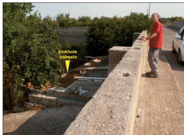
Fig. 14 – Evidenza attuale di un antico sprofondamento colmato dopo gli anni 70. – Present evidence of an ancient sinkhole, filled after the 1970s.
