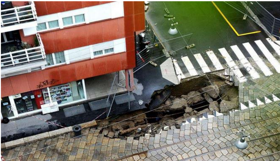
Foto 2.3.6 – Voragine apertasi in Via di Porta Romana, Milano 28 luglio 2014 (Fonte: http://www.skytg24.it )
