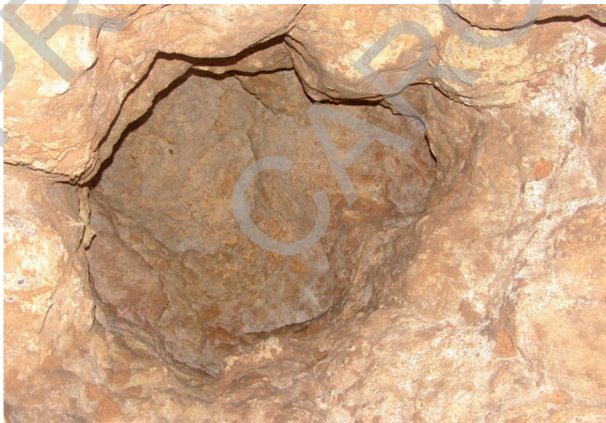
Fig. 77 – Domo di corrosione sulla volta.
