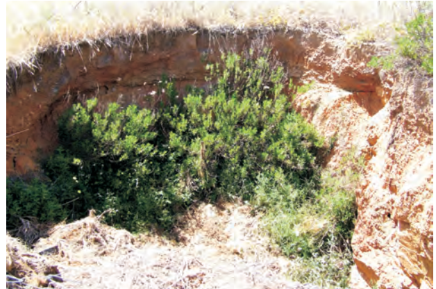
Fig. 12 - Dettaglio di una voragine. - Detail of the sinkhole.
