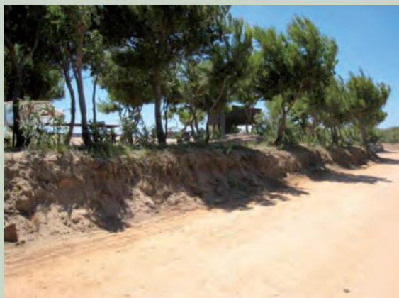
Fig. 30: Scarpata sabbiosa in erosione
