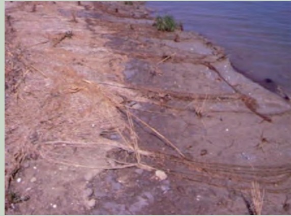
Fig. 4: Totale inefficacia dell'impiego di stuoie di juta quale antierosivo spondale
