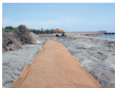
Fig. 9.14: Ricostruzione di nucleo dunale a protezione di un canale di bonifica (Loc. Valmontorio - Latina)
