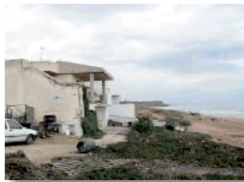
Abitazioni abusive costruite in totale assenza di titoli edificatori nella località balneare di Triscina di Selinunte
