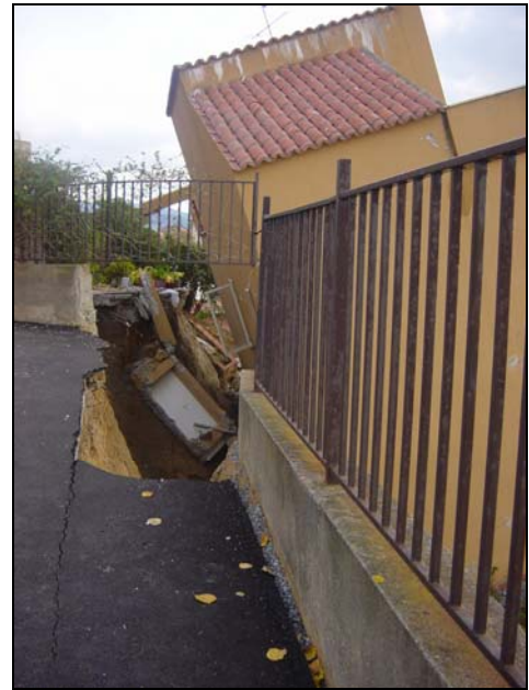
Figura 23.32 Particolare della frana precedente vista dalla zona di coronamento.
