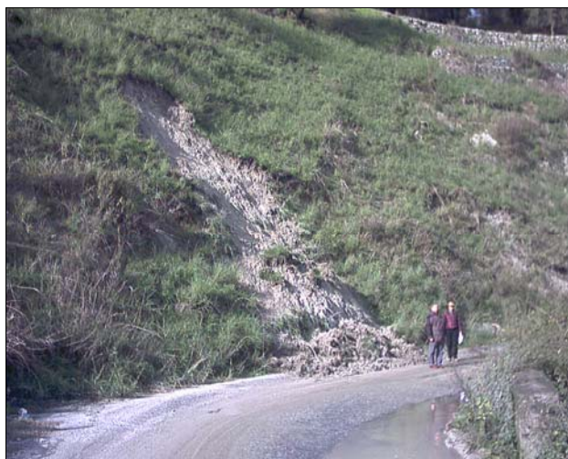
Figura 23.28 S.P. Palmi San Procopio (Ponte Mangano). Scorrimento-colata in materiali di copertura a granulometria fine, con invasione della sede stradale.
