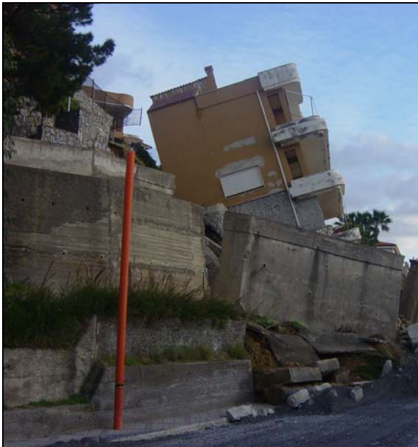
Figura 23.31 Belvedere Marittimo. Frana rotazionale che ha investito un palazzo, la SS 18 e la ferrovia.
