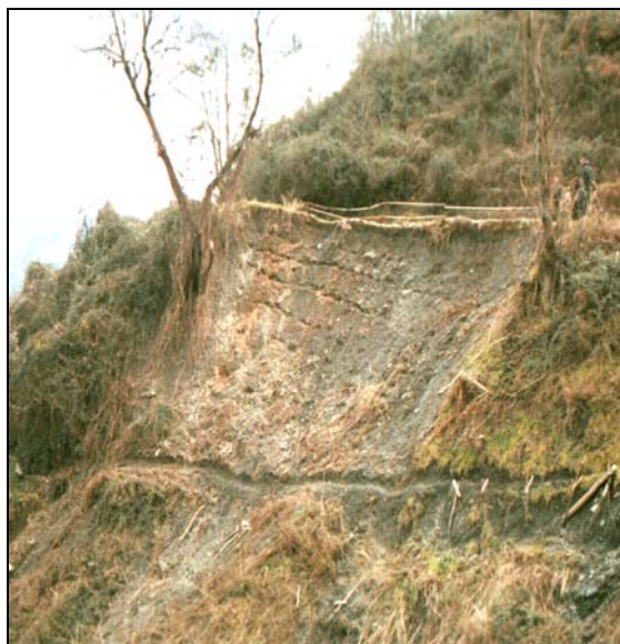
Figura 23.18 Martirano Lombardo (CZ): esempio di frana per scorrimento superficiale nelle metamorfiti di basso grado (in particolare nella coltre argillificata di alterazione superficiale) che ha interessato una strada comunale.
