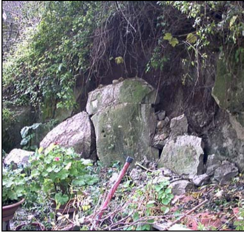
Figura 23.29 Esempio di crolli di blocchi nelle arenarie mioceniche.
