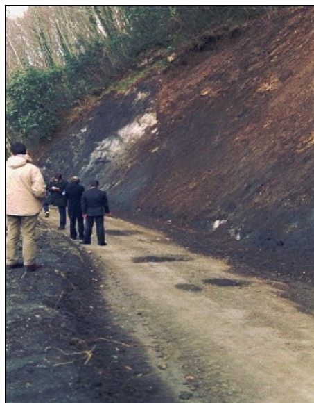
Figura 23.19 Martirano (CZ): esempio di frana per scorrimento superficiale nelle coperture di alterazione delle metamorfiti di basso grado, con danni alla viabilità e crollo di opere di sostegno.
