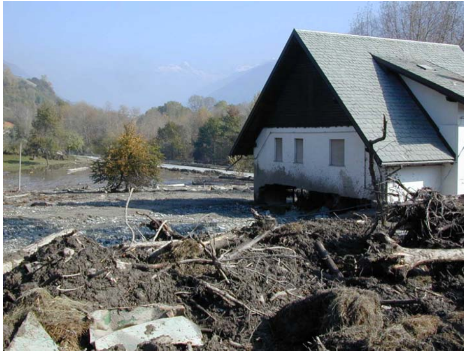
Figura 3.14 Abitazione investita da un colata rapida di fango e detrito nei pressi della Strada Statale n. 26 della Val d'Aosta, Messigny.
