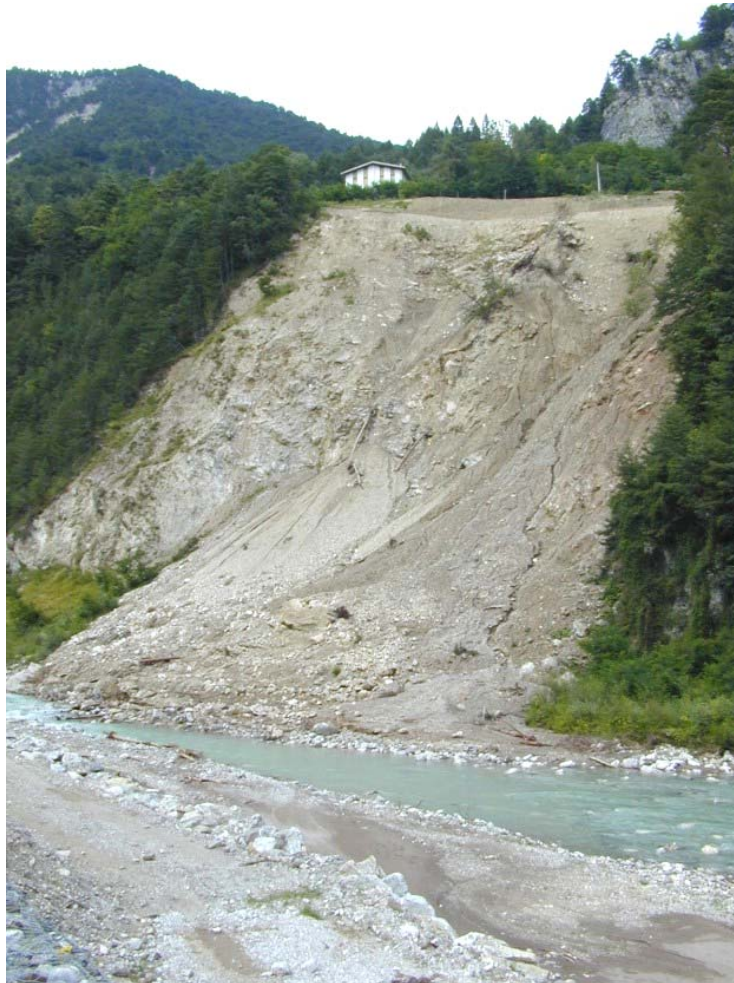
Figura 3.17 Frana di S. Andrea in prossimità dell'abitato di Perarolo di Cadore (BL) riattivata il 18/11/2000 dopo le intense precipitazioni del mese di ottobre 2000. L'intensa fratturazione e le scadenti caratteristiche geomeccaniche e del substrato anidridico-gessoso e calcareo costituiscono i fattori predisponenti all'instabilità del versante.
