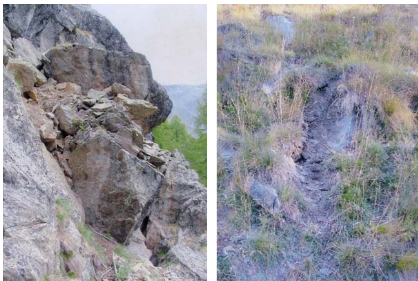
Figura 8.11 a) Massi instabili; b) Solco di rotolamento.
