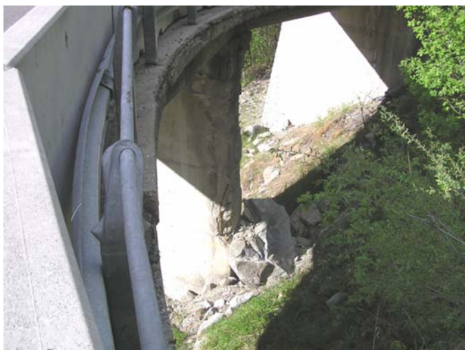
Figura 8.13 Corpo di frana sui tornanti al km 6,700 della SP48.
