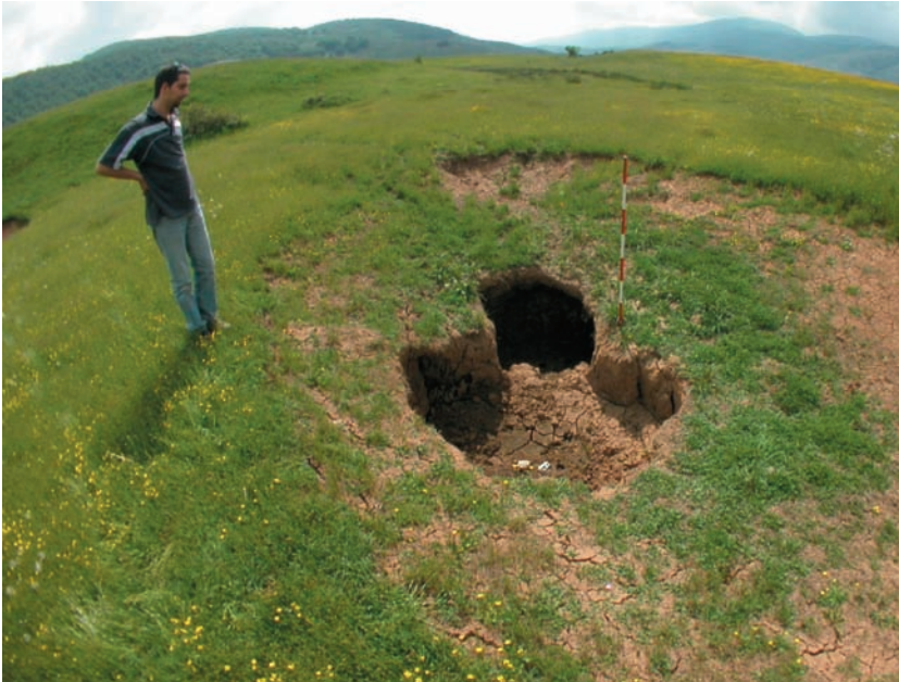
Foto 5 - Piano di Rascino. Località "Fossa del Mulino". Voragine del giugno 2002.
