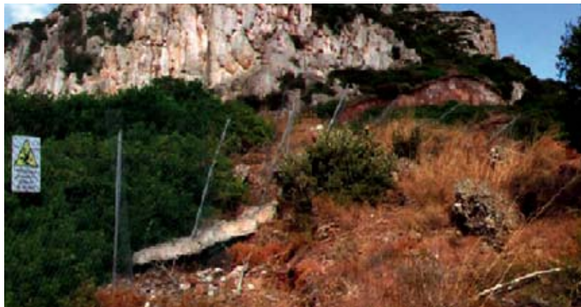
Fig 8 - Primo piano del settore in subsidenza con evidenza della parete di taglio al limite con i calcari.
