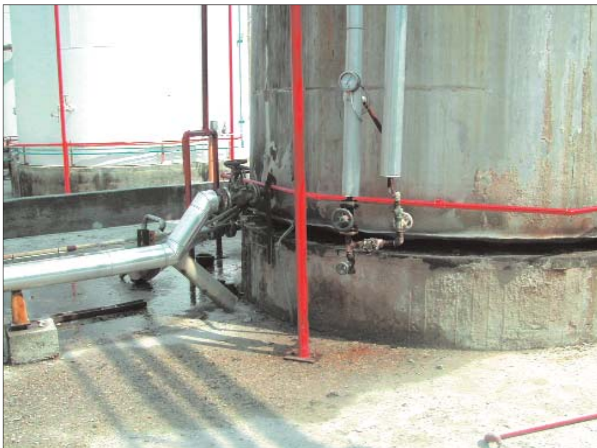
Figura IX.7 – Fondo del serbatoio con tubazioni acqua (disconnesse) e tubazioni vapore. Deformazione del fondo per imbutitura da sovrappressione interna.
