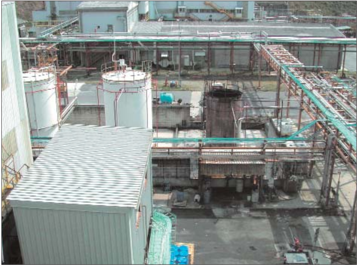
Figura IX.9 – Parco stoccaggi, unità produttiva e pipe-rack. Serbatoio scoperto.
