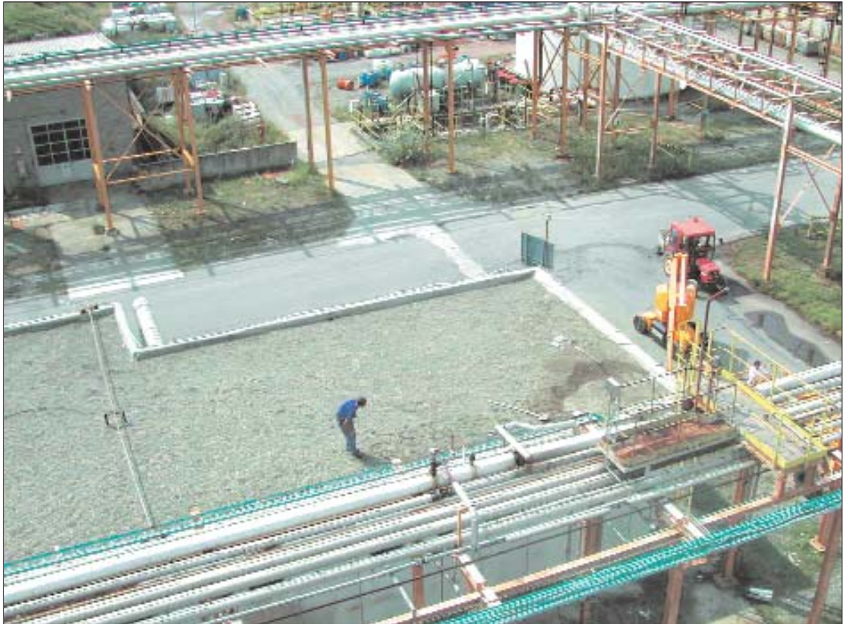
Figura IX.10 – Tetto cabina elettrica danneggiata e punto di caduta del tetto del serbatoio.
