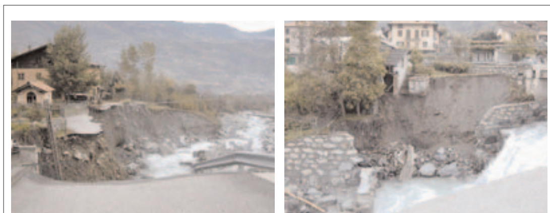
Figura 4.6: Zona subito a valle del ponte tra Fontillon e Miseregne: si nota l'erosione sia della sponda sinistra che destra e la distruzione delle difese spondali realizzate solo 7 anni prima, nel 1993.
