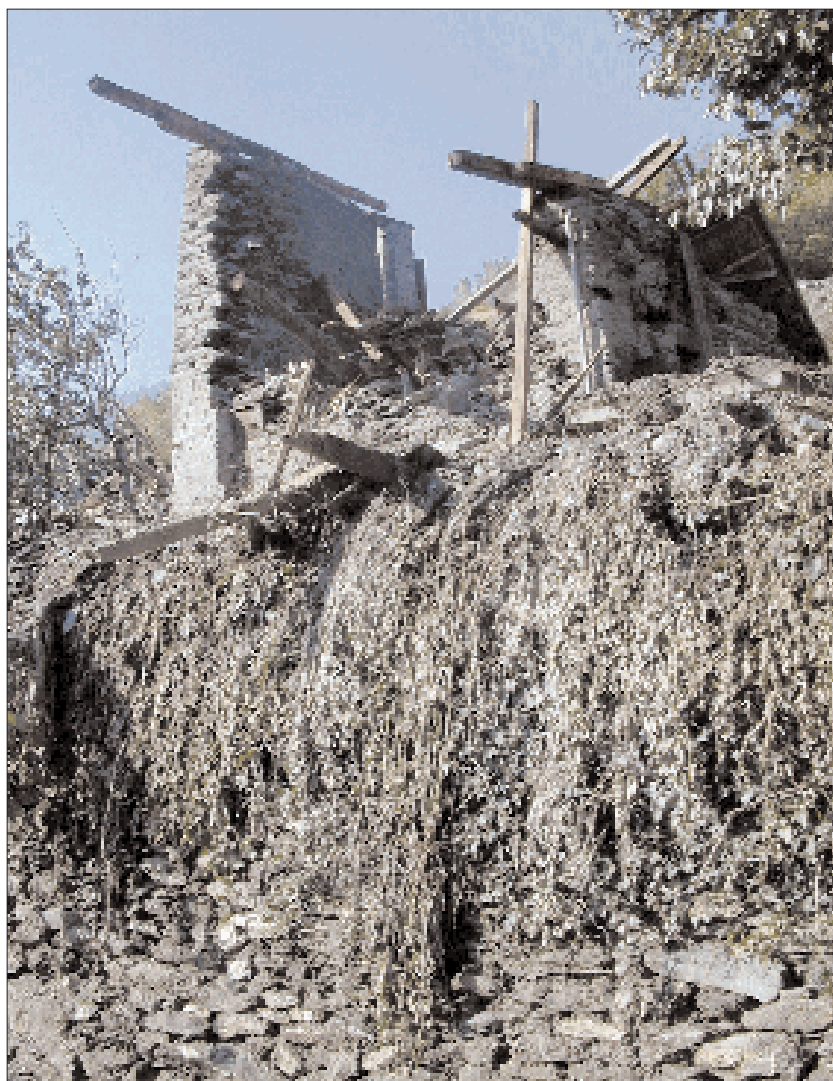
Figura 4.19: Una abitazione di Rovarey de Verres distrutta dallo stesso scorrimento.
