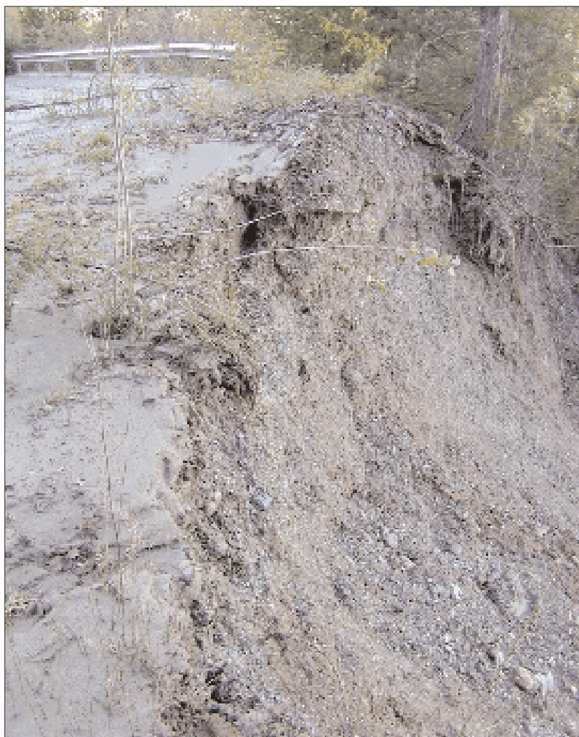
Figura 4.10: Frana iniziata al ciglio di una strada che sale a tornanti sul versante che guarda Rovarey e Miseregne.
