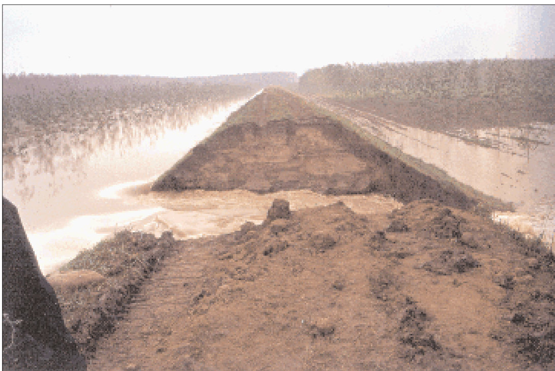
Figura 4.44: Rottura dell'argine golenale di Serravalle-Libiola in località Le Fornaci.
