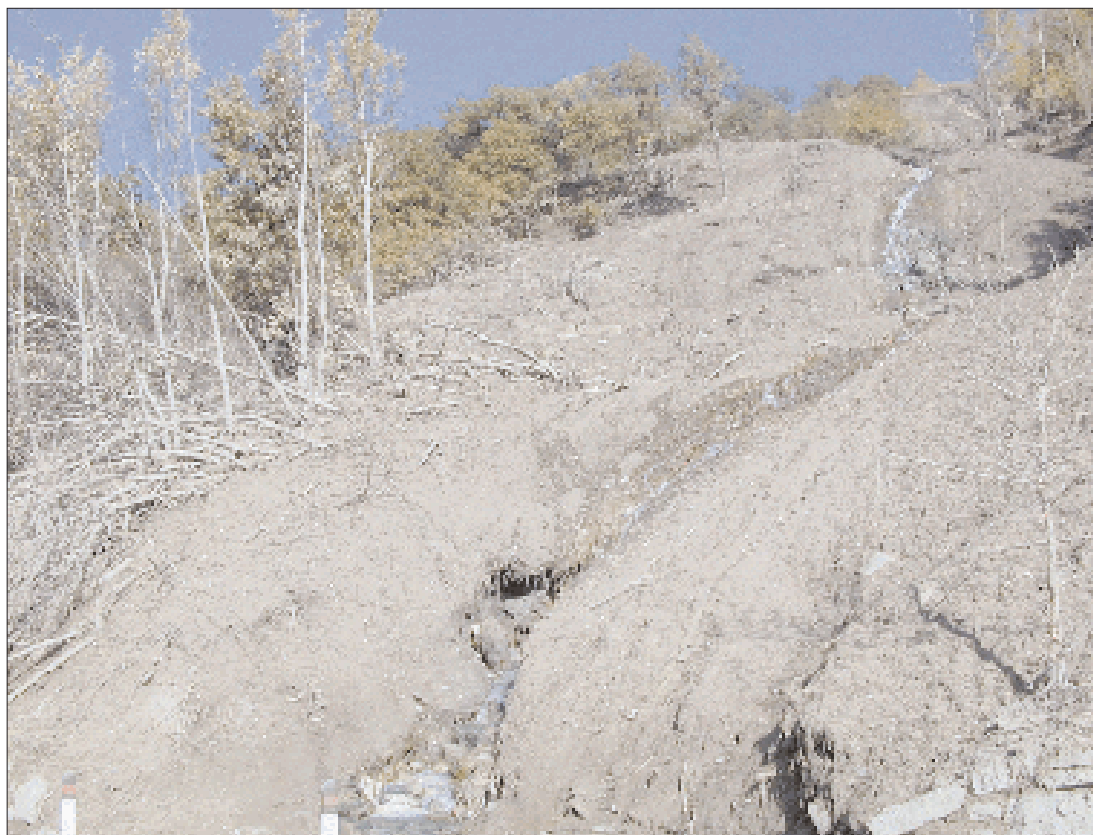
Figura 3.2: Porzione terminale di una frana che ha investito la SS 26 ad est di Nus: alcuni giorni dopo l'evento presentava ancora abbondante acqua di ruscellamento concentrato.
