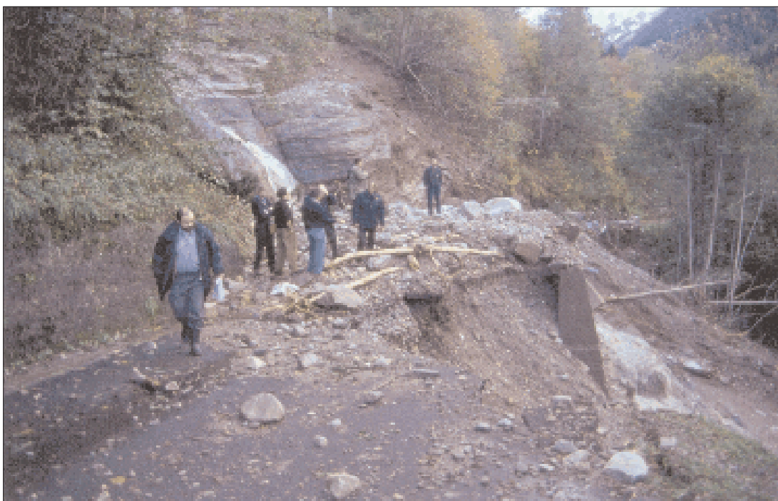
Figura 4.35: Danneggiamento della strada per Trasquera in sponda destra del torrente Cairasca.
