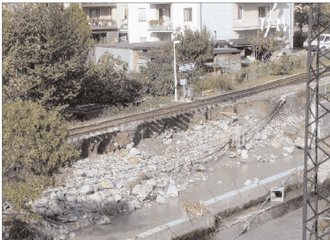
Figura 4.3: Quincinetto, in prossimità del casello autostradale: sede ferroviaria sottoscavata da un ramo laterale della piena della Dora Baltea.
