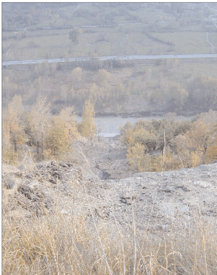
Figura 4.17: La frana del km 87 della Strada Statale vista dal coronamento verso la Dora. È evidente il solco di ruscellamento che sta incidendo il corpo della frana.
