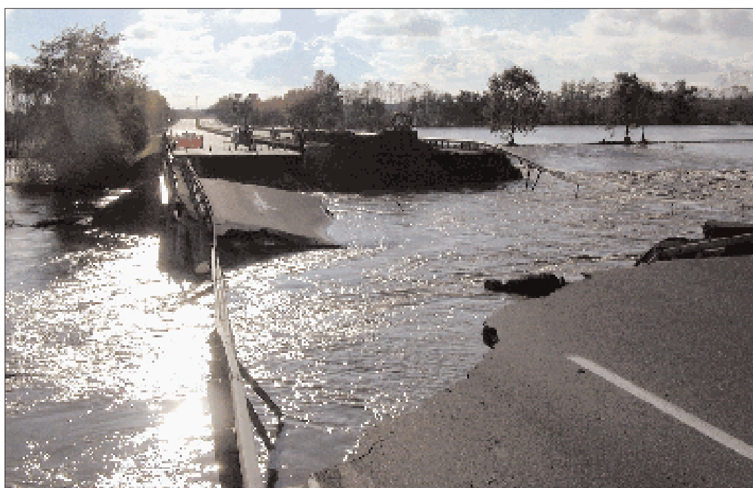
Fig. 4.37: Mattina del 17 ottobre. Viadotto dell'autostrada Milano-Torino in corrispondenza del ponte sulla Dora Baltea. Contrariamente a quanto riportato dalle principali fonti d'informazione il crollo di parte della struttura non è stato prodotto dall'azione del fiume ma da quella del canale di derivazione.
