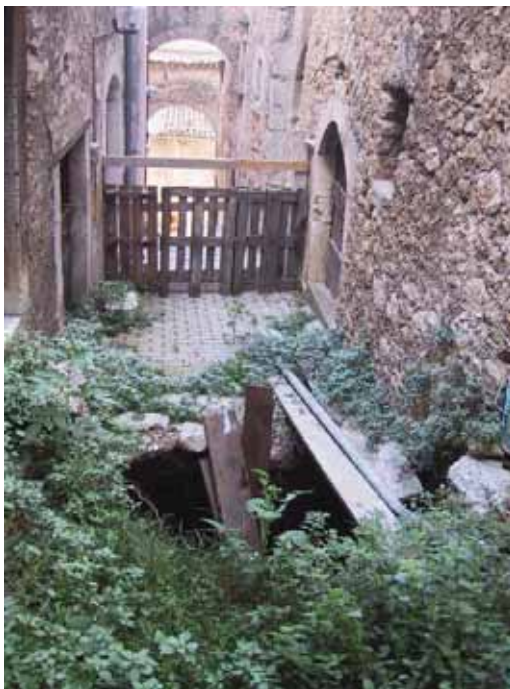
Fig. 8 - S. Pio delle Camere: sprofondamento verificatosi nel 2004. L'ubicazione è riportata in fig. 7. Fonte: Comune di S. Pio delle Camere
