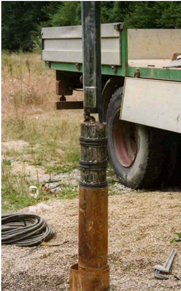
Pompe sommerse: fenomeni di corrosione
