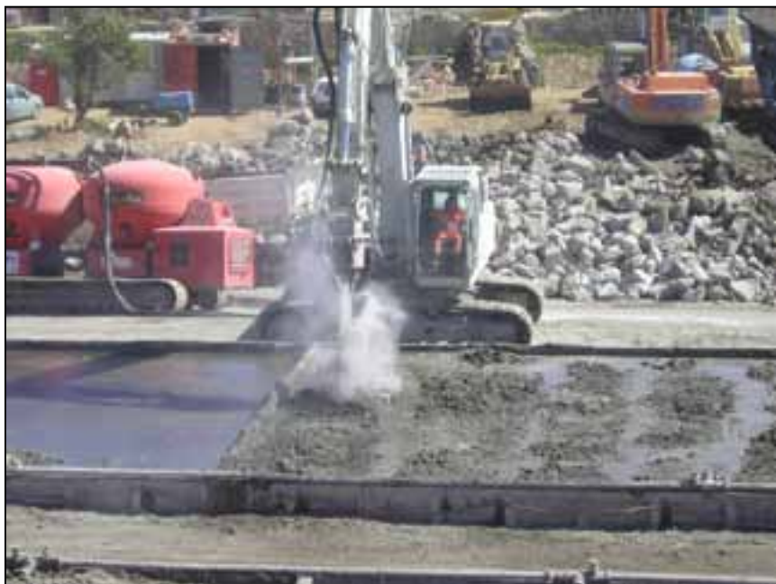
Trattamento in vasca di prefabbricata
