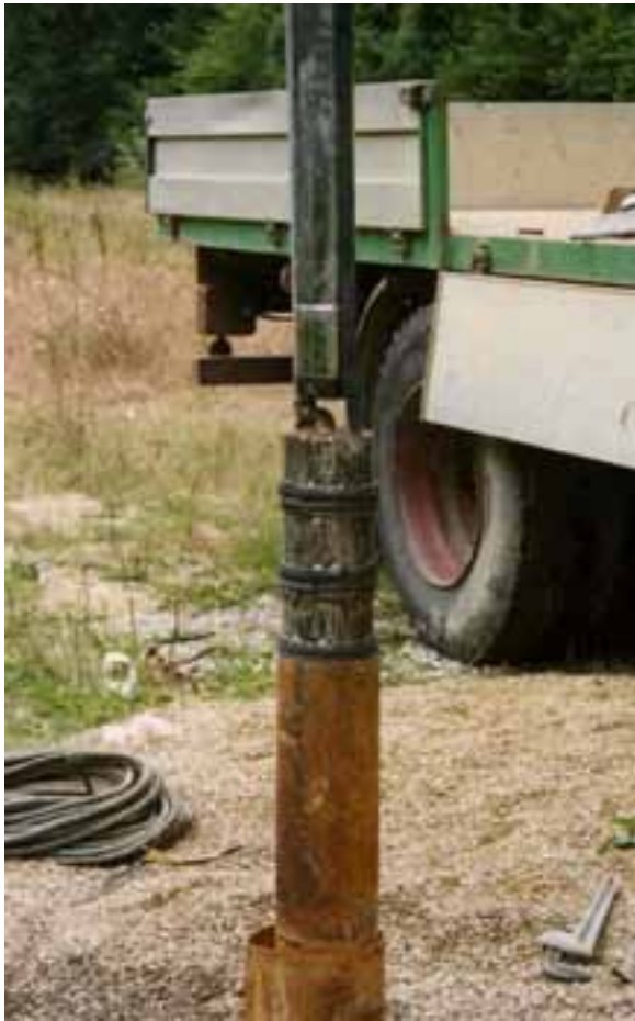
Pompe sommerse: fenomeni di corrosione
