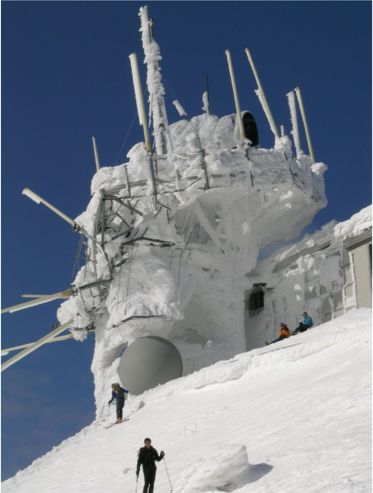
Fig. 2.7: Fotografia dei danni provocati dalla neve in febbraio al pilone che sostiene le antenne sul Monte Cimone (Emilia-Romagna; foto scattata il 10 febbraio 2009 da Enrico Pacini). Cortesia Consorzio LaMMA, IBIMET-CNR ( http://www.lamma.rete.toscana.it/ ).
