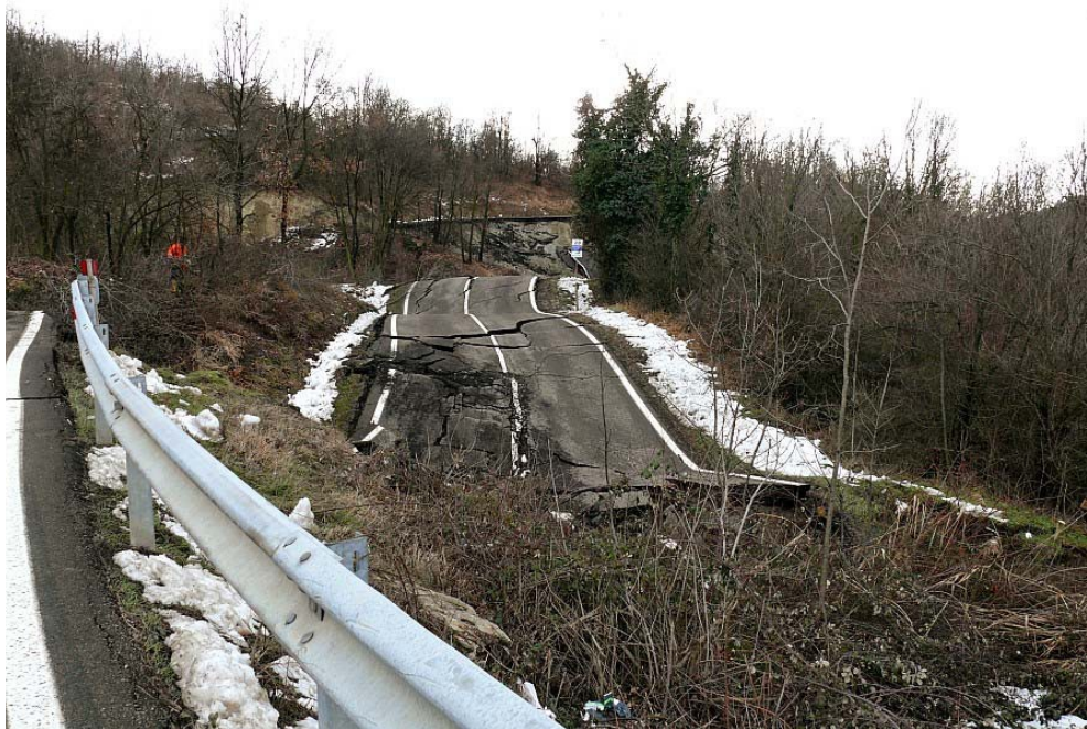
Fig 2.6: Comune di Guiglia dissesto della strada provinciale SP623 in seguito all'attivazione della frana nei giorni seguenti l'evento del 20-21 gennaio 2009 (cortesia ARPA-SIMC Emilia-Romagna).
