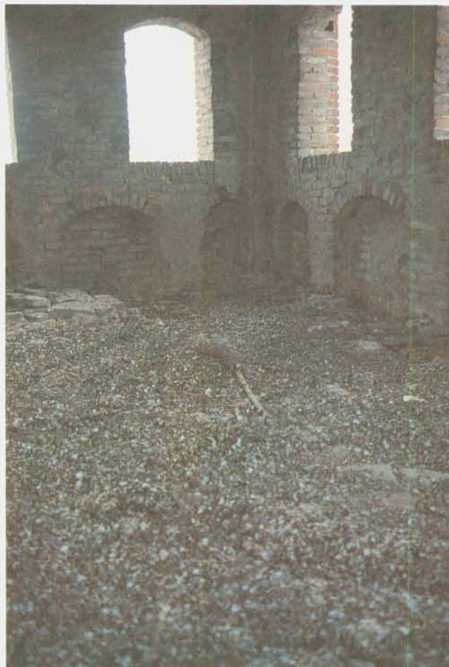
Fig. 8 - Lo stato di degrado causato dall'accumulo di guano in un edificio storico (foto Mongini).
