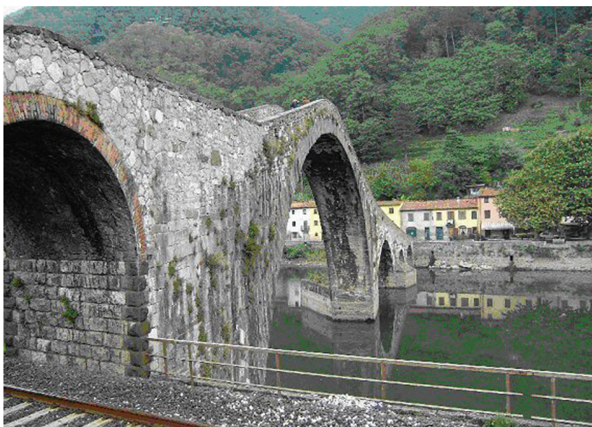
Figura 2.9 - Caratteristico ponte in pietra, nel quale le fessure presenti tra i mattoni possono essere utilizzate come rifugio (Foto P. Agnelli).
