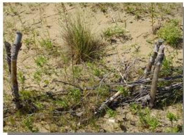
Barriere antivento sfasciate (Cà Savio)
