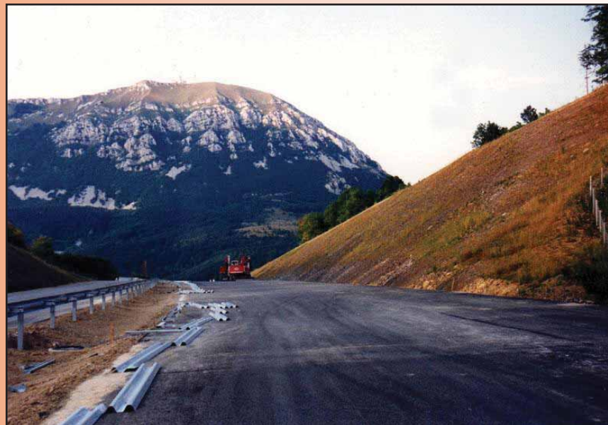
Foto 1 - Scarpata in trincea in roccia lavorata a bassa pendenza e a tirata unica senza berme intermedie. Autostrada Capodistria-Lubiana, Località Razdrto (Slovenia).
