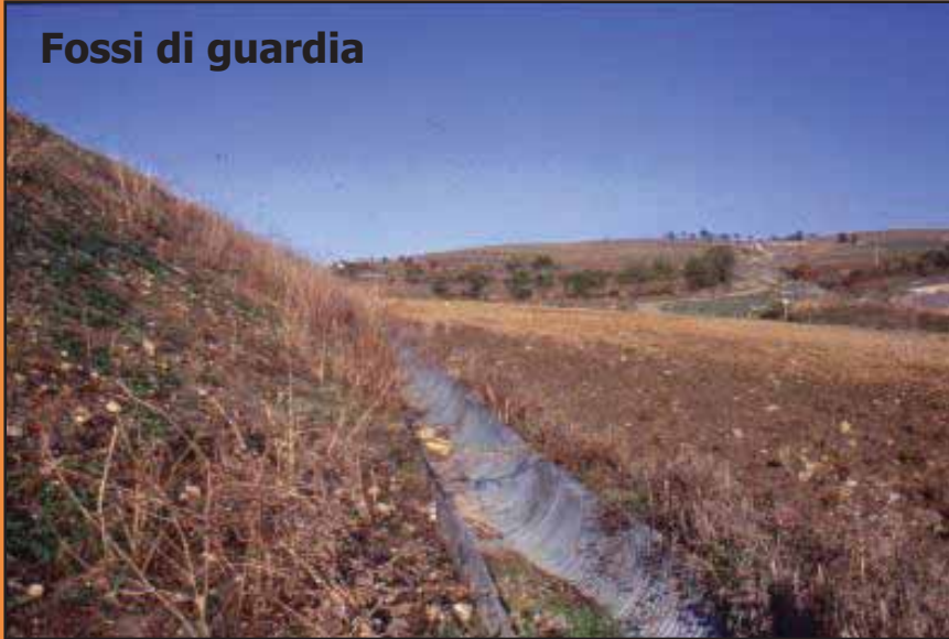
Foto 25 – Canaletta in metallo con problemi di sifonamento
