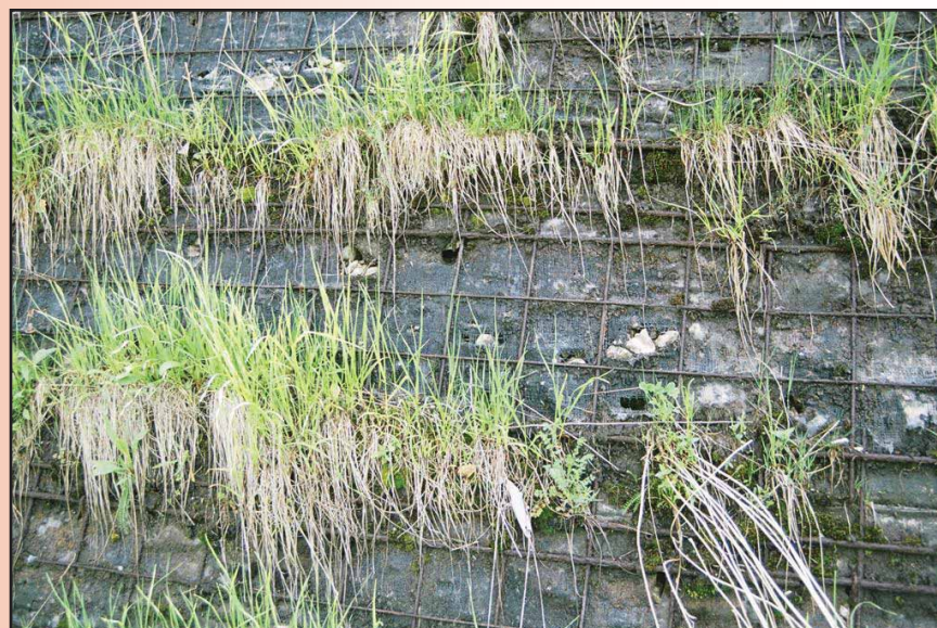
Foto 50 - Evidente assenza di terra vegetale e stuoie inadeguate limitano la crescita delle erbe alle strisce di contatto tra gli strati delle armature orizzontali
