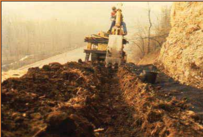
Foto 27 - Fosso di guardia in geostuoia tridimensionale sintetica seminata, intasata di ghiaio e bitumata in loco (sequenza foto 27 ÷ 30) Autostrada dei Trafori anni '80
