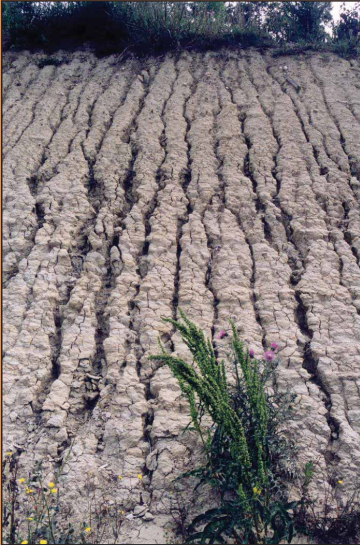
Foto 2 - Inizio di solchi di erosione su scarpate non rivegetate in trincea in litologia sciolta a matrice argillosa. 3° corsia autostrada Orte-Fiano
