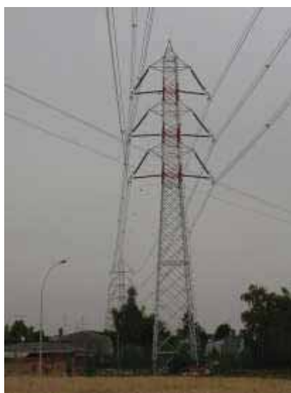
Figura 3 - Tipologia di sostegni: traliccio a mensole isolanti.
