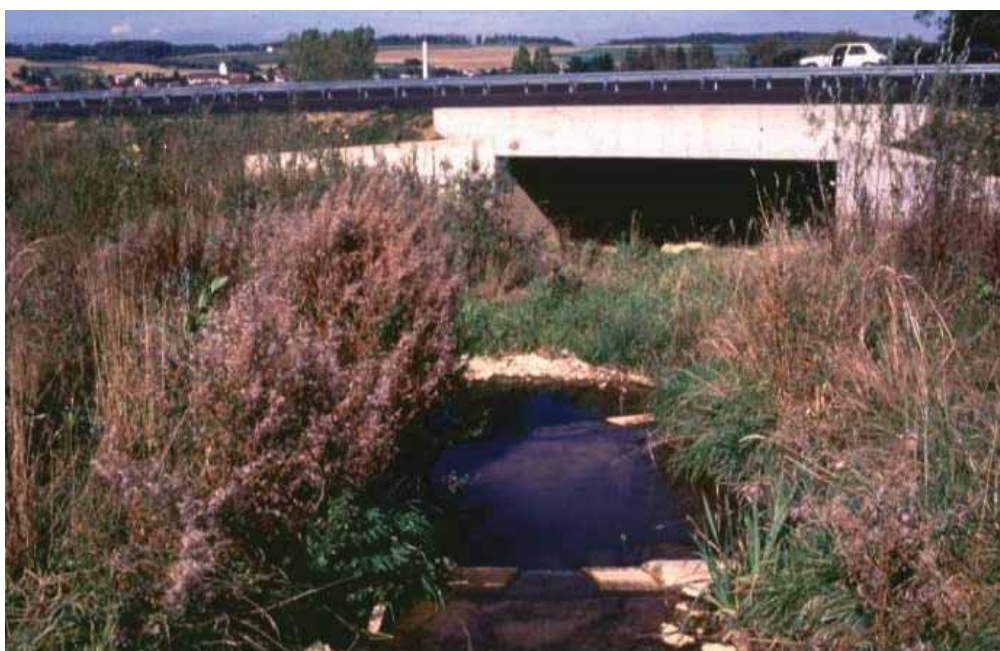
Esempio di un canale sotterraneo lungo la nuova Autostrada Jura Svizzera-Francia (M. Bacci).
