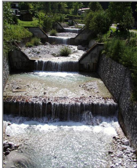
Figura 4.27 – Alveo a fondo artificiale sistemato con briglie ad interdistanza ridotta. (T. Pramper, Belluno).
