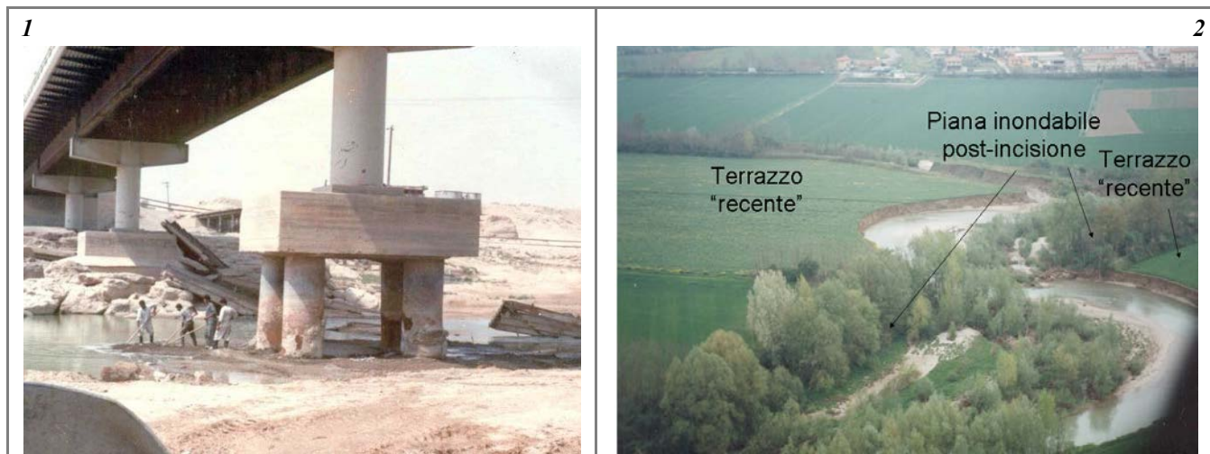
Figura 81 – Evidenze sul terreno di incisione. (1) Erosione alle pile dei ponti; (2) dislivelli tra piana inondabile post-incisione e terrazzo recente (corrispondente alla piana inondabile pre-incisione).
