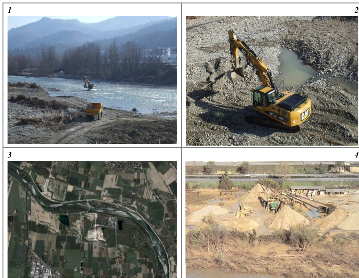
Figura 75 – Rimozione di sedimenti. (1) e (2) Attività recente o attuale; (3) e (4) indicatori indiretti di intensa attività passata sono la presenza di zone di cava (3) e frantoi (4) e strade camionabili nelle adiacenze del corso d'acqua. L'attribuzione alla Classe B o C dipende dall'estensione degli interventi (localizzati o diffusi), nel caso di alvei confinati, e dall'intensità dell'attività di escavazione sia in tempi recenti che passati nel caso di alvei semi- e non confinati.
