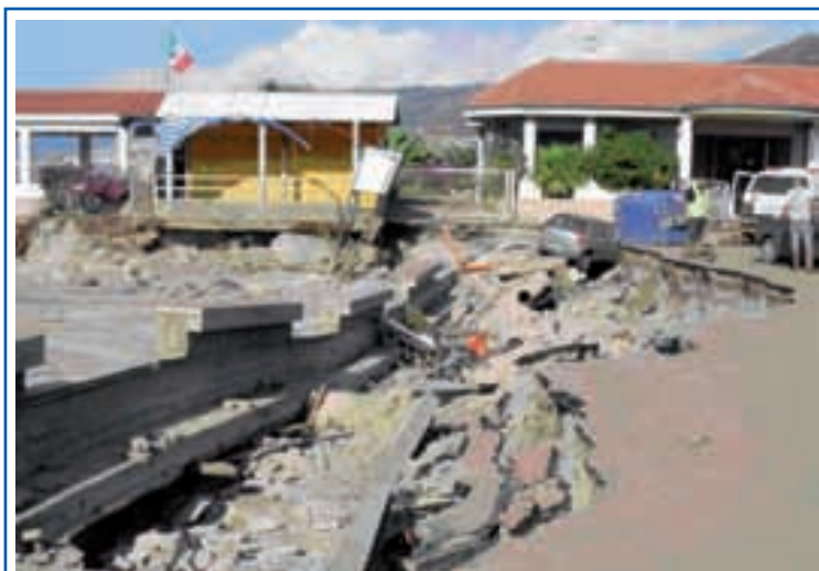
Figura 7.19: Dissesti presso la costa di Vibo Marina (VV) avvenuti nell'estate del 2006 21
