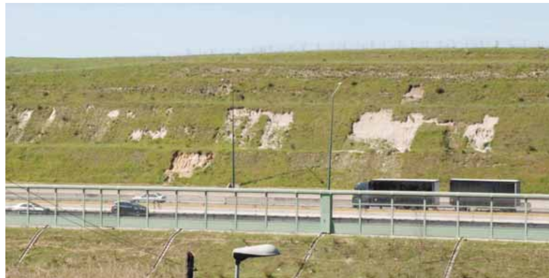
Colate superficiali sui versanti artificiali all'esterno del GRÀ, altezza svincolo Boccea; Gennaio 2009 (Foto Marco Amanti)
