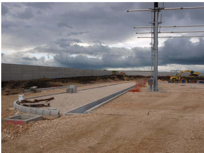
Foto 41 - scarpata interna della recinzione con muro in cls rivegetabile. SE di S. Severo (FG) a servizio della Centrale a turbogas in costruzione. (Foto G. Sauli, febbraio 2010)
