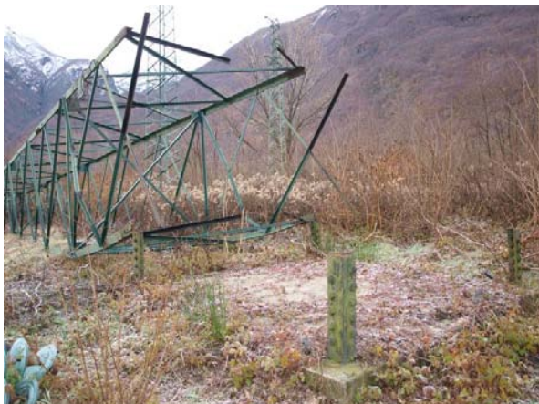
Foto 88 - Nuova linea 132 kV loc. Pieve Vergonte (VB). Fase di demolizione di vecchie linee. (Foto G. Sauli, dicembre 2009)
