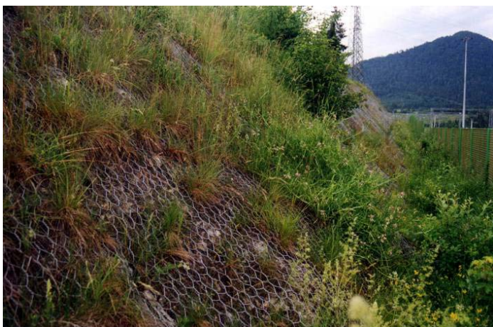
Foto 9 - Rivestimento vegetativo in rete metallica e stuoia organica. Stazione FS, Tarvisio-Boscoverde. (Foto G. Sauli, giugno 2003)
