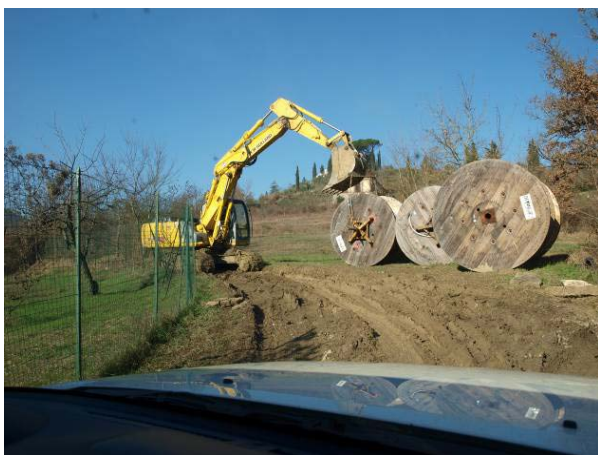
Foto 86 - Trasporto dei conduttori tramite piste temporanee; S. Barbara (Scandicci, FI). (Foto G. Sauli, gennaio 2010)
