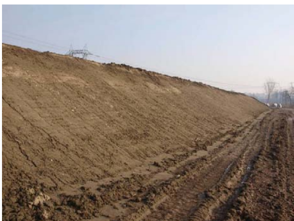
Foto 47 -Formazione di rilevati di mascheramento con utilizzo dei materiali di scotico misti a inerte di cava. SE di Maleo (LO) (Foto G. Sauli, inverno 2011)
