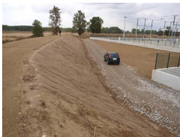
Foto 48 -Completamento terrapieni di mascheramento con stuoie antierosive in juta. Nuova S.E. di Chignolo Po (PV). (Foto G. Sauli, estate 2011)
