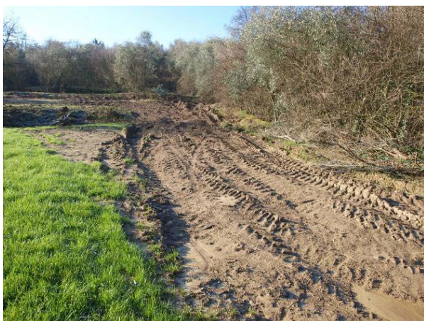
Foto 84 – Piste di accesso ai minicantieri, da ripristinare a fine lavoro; S. Barbara (Scandicci, FI). (Foto G. Sauli, gennaio 2010)
