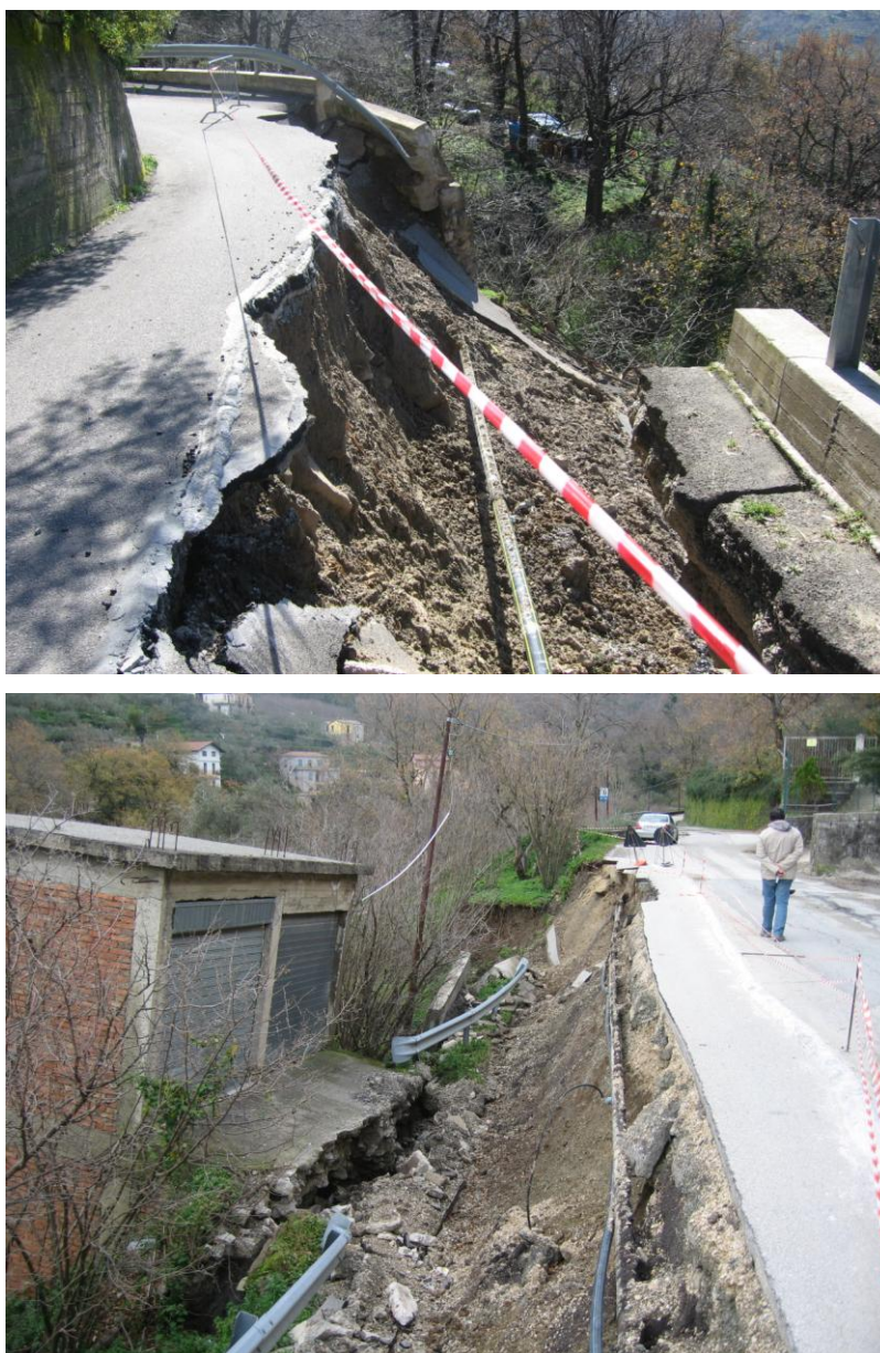
Figura 2.20: Foto dei danni provocati dalle frane del 18 Ottobre 2011 presso Nebrodi. Fonte: Dipartimento di Protezione Civile Nazionale.
