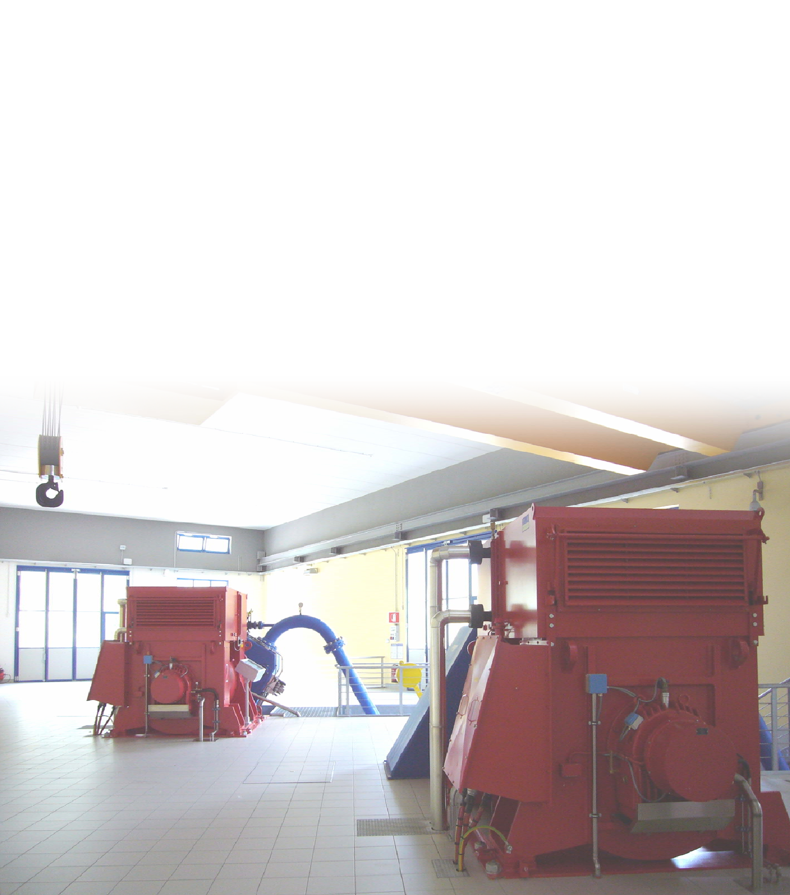
Centrale idroelettrica Gais I
