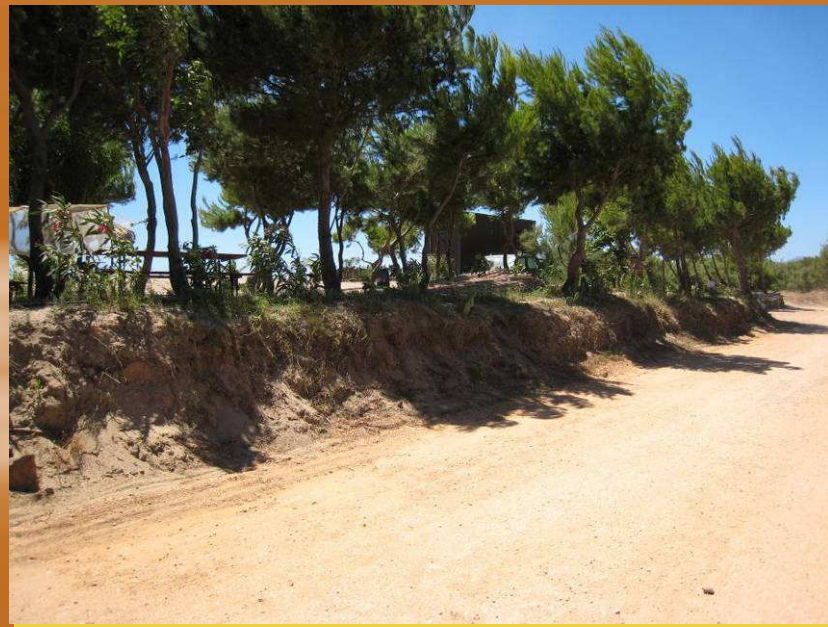
Foto: 30: Scarpata sabbiosa in erosione, P. Cornelini
