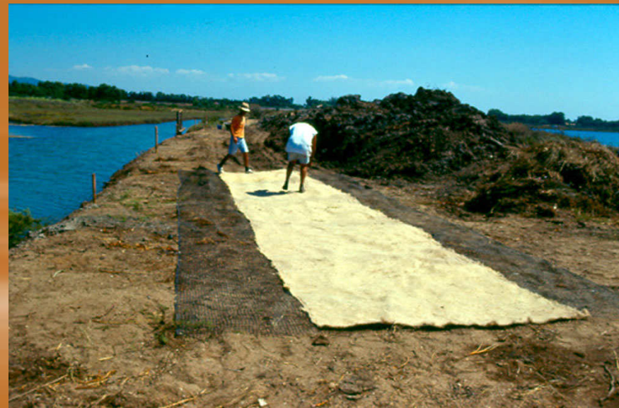
Foto 57: Laguna di Nora (CA), rullo spondale, fase di costruzione 1996 - Foto G. Sauli
