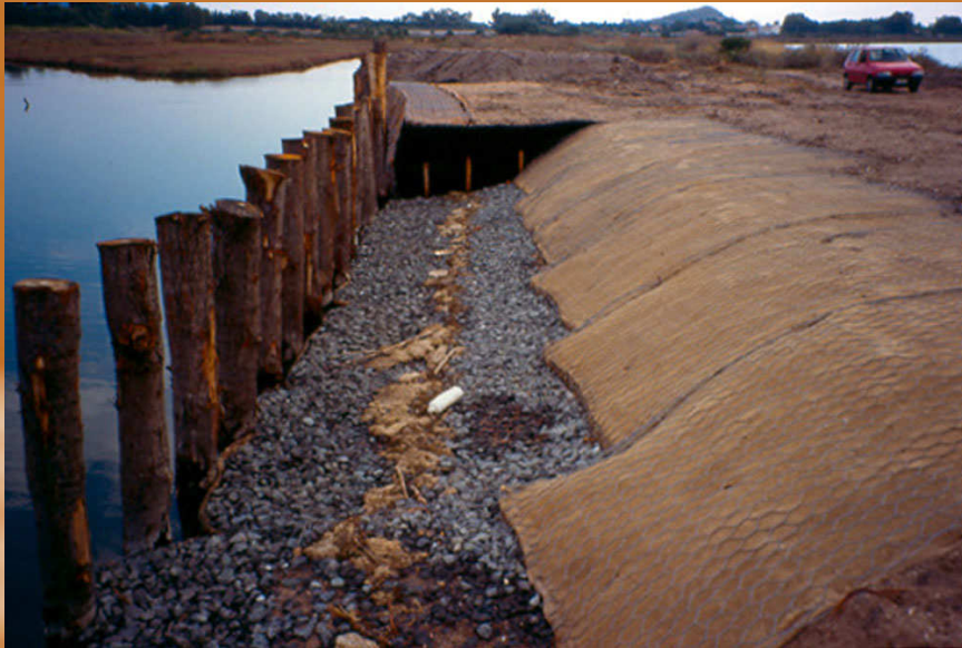
Foto 53: Terra rinforzata verde, materassi verdi spondali. Laguna di Nora (CA) 1996Foto G. Sauli
