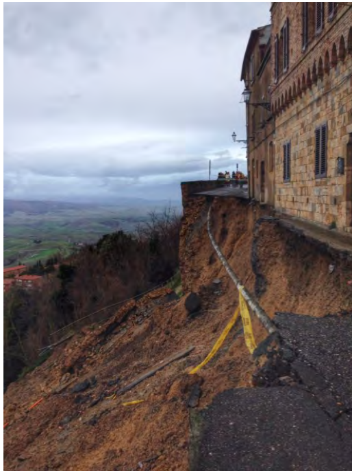
31/01/2014 Frana mura medioevali di Volterra (PI)
