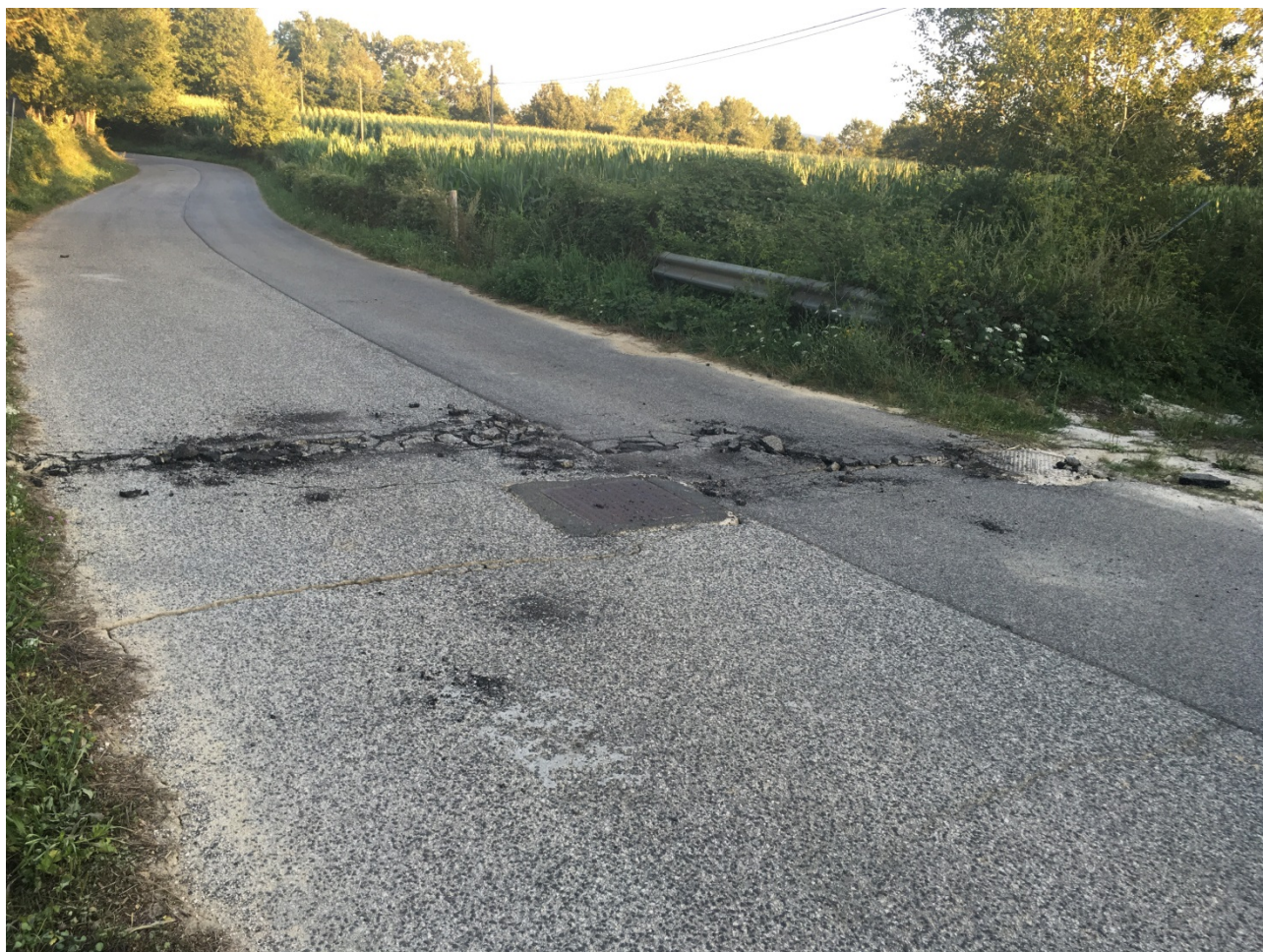
Figura 1 - Fratture minori sul manto stradale tra Sant'Angelo e san Lorenzo Flaviano
