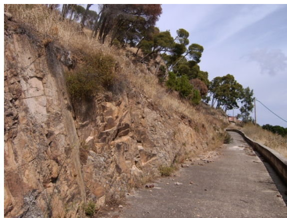
Area soggetta a crolli e ribaltamenti diffusi con associati scivolamenti - Comune di Villacidro – loc. Cuccureddu
