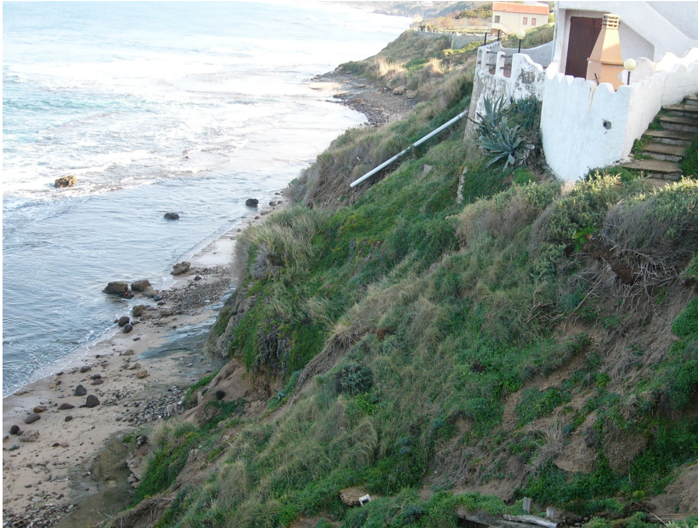
Area con fenomeni franosi complessi con crolli al piede della falesia su litologie piroclastiche - Comune di Valledoria, località La Ciaccia
