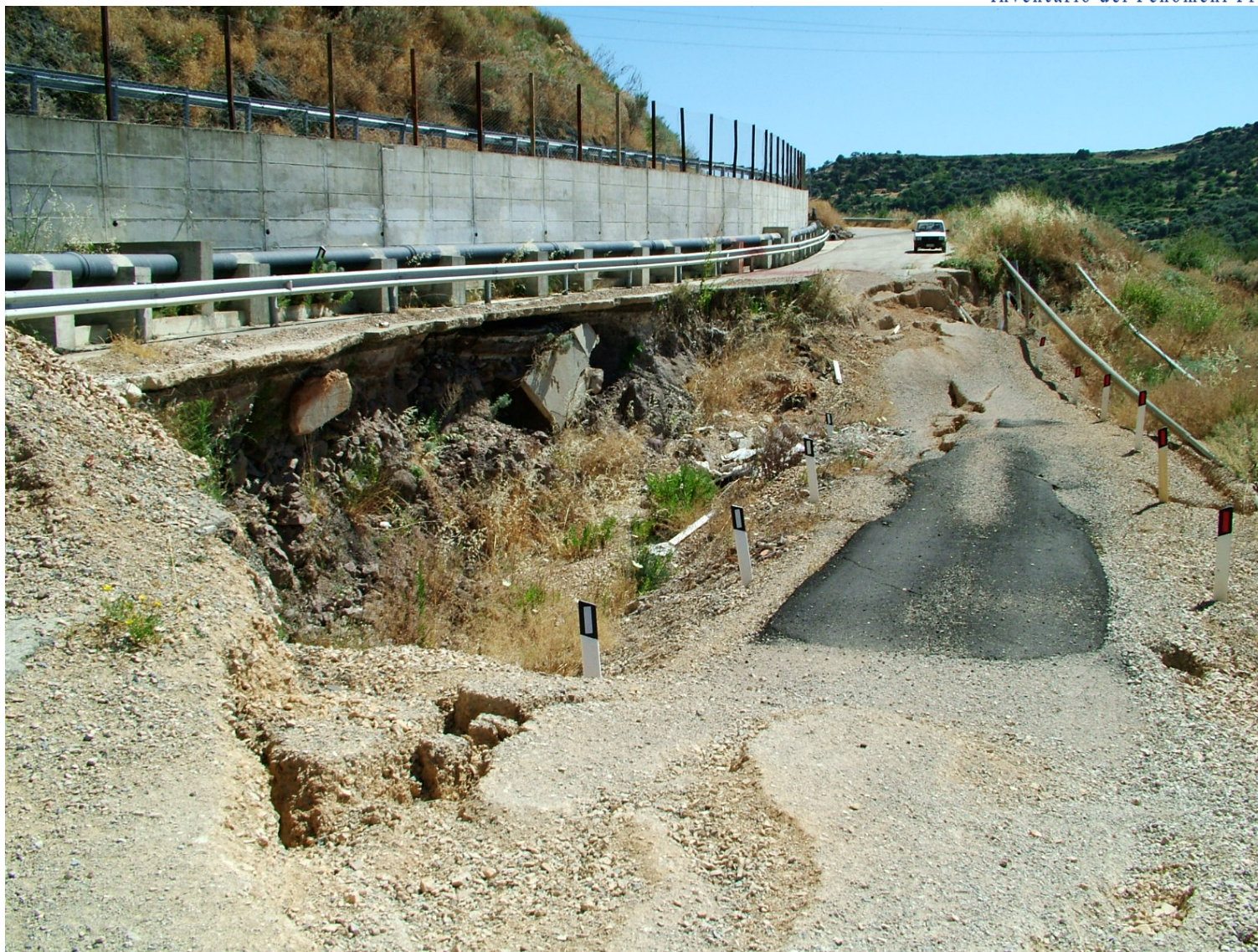
Frana di scivolamento rotazionale unita a crollo - Comune di Ittiri – strada provinciale n°41 bis Ittiri-Banari.
