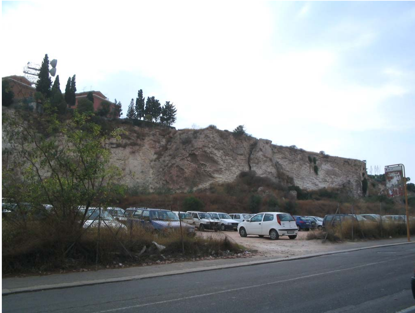
Fenomeni di crollo e ribaltamento in litologie carbonatiche a ridosso della Via Is Maglias - Comune di Cagliari
