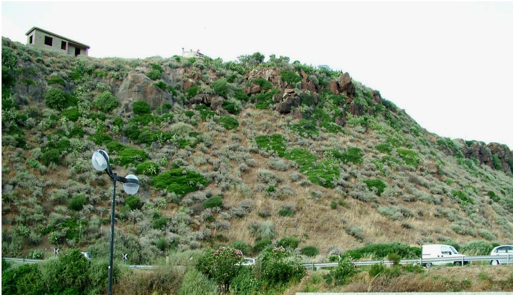
Area soggetta a crolli e ribaltamenti diffusi in litologie ignimbriche - Comune di Castelsardo – Loc. Mulinacciu
