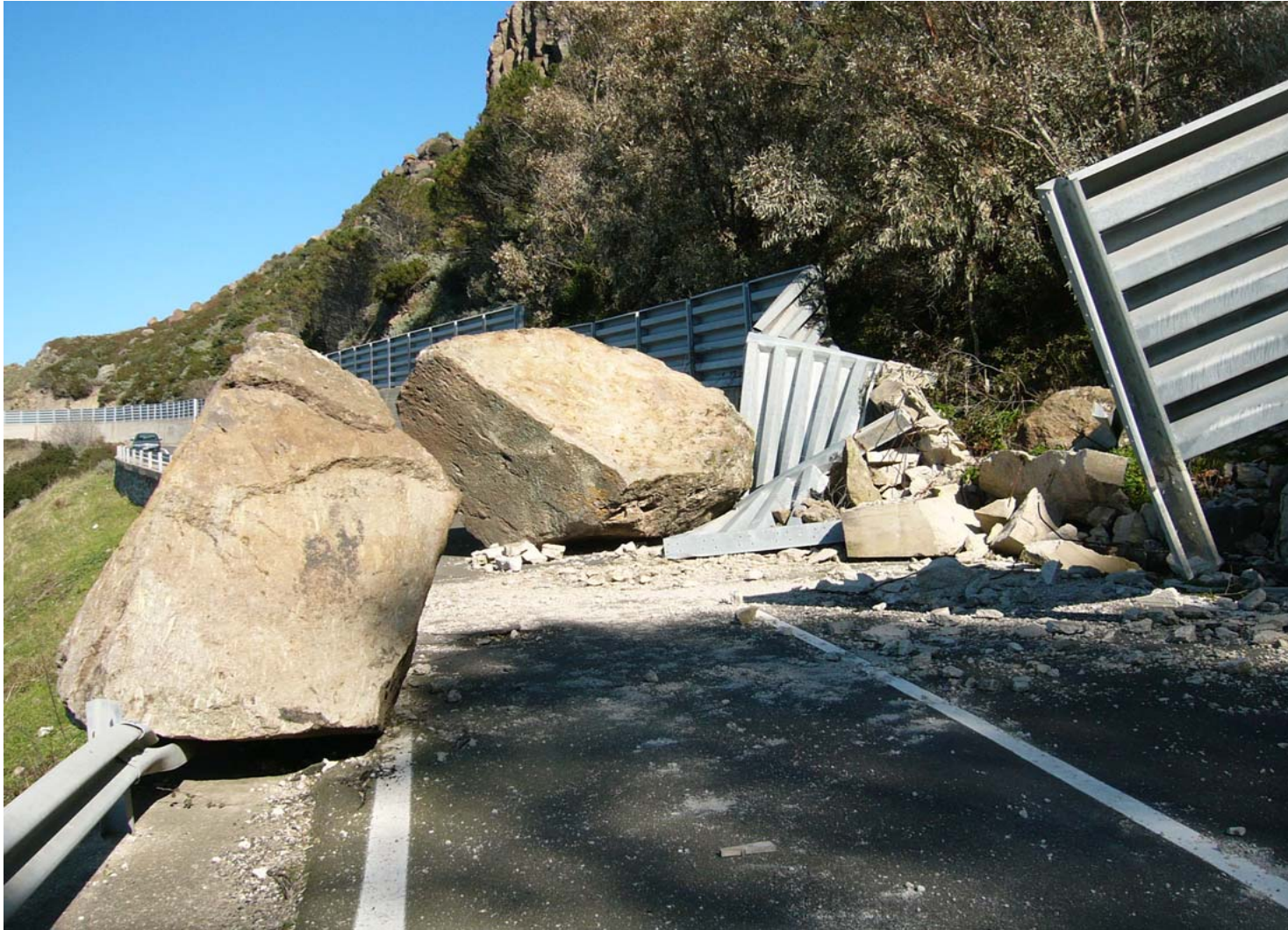
Fenomeni di crollo e ribaltamento di blocchi di litologie ignimbriche- Punta Spinosa Strada Statale n°134 (tratto Castelsardo-Sedini)
