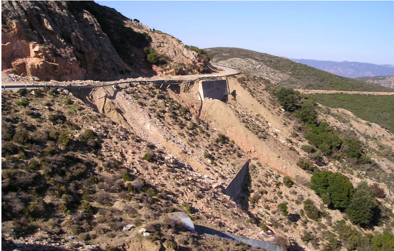
Fenomeni di scivolamento rotazionale e traslativo in Comune di Villagrande Strisaili (NU) – loc. Serra Isadalu
