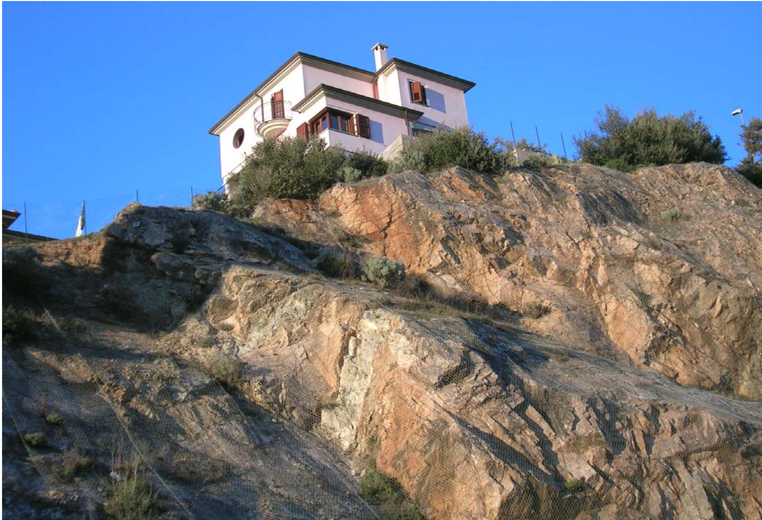
Area soggetta a crolli e ribaltamenti diffusi in metamorfiti - Comune di Ozieri (SS)
