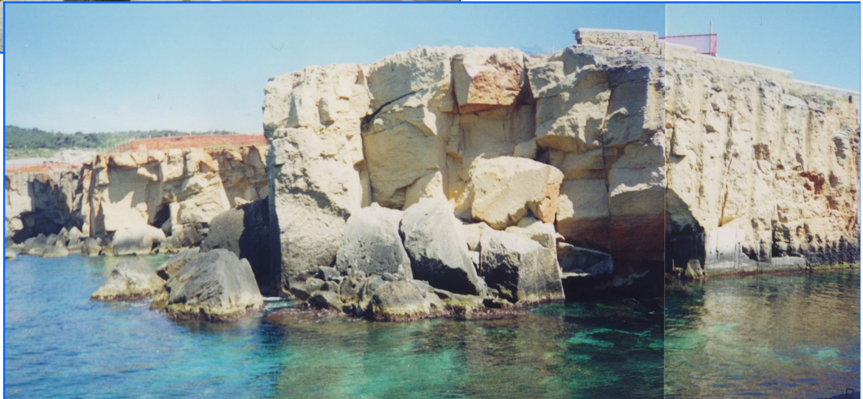
Crolli a Porto Miggiano (S. Cesarea Terme) presso un villaggio turistico in costruzione
