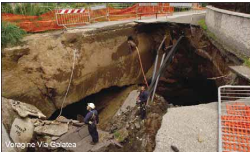
Fig. 6 - Sinkhole a Via Galatea: vista della voragine e della volta della cavità sottostante (foto dell'Associazione "Roma Sotterranea").
