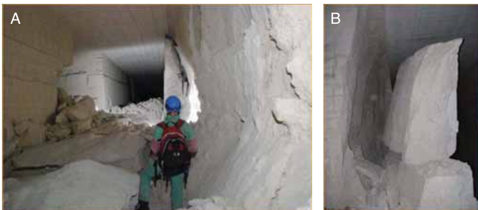
Fig. 5 - a) Dissesti in parete delle gallerie ed accumulo di materiale sul piano di calpestio; b) distacco di blocco colonnare dalle pareti della galleria
