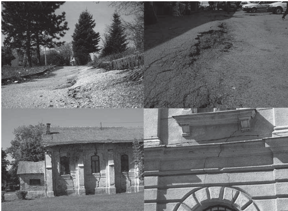
Fig. 8 - Esempi di fratture presenti nel centro di Tuzla e sui palazzi storici.
