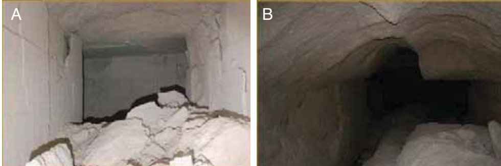
Fig. 4 - a) Dissesto dell'intera volta delle gallerie ed accumulo di materiale sul piano di calpestio; b) dissesto di una porzione del tetto della galleria
