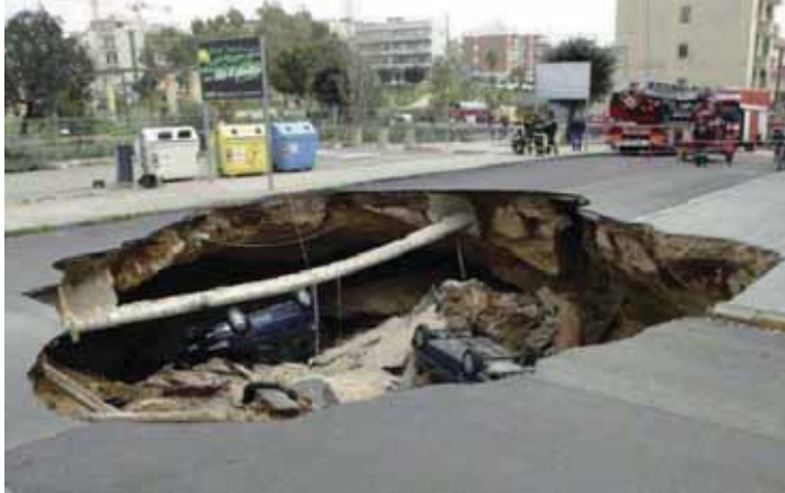
Fig.13 - Voragine presso il centro urbano di Gallipoli che ha coinvolto alcune auto vetture (1 aprile, 2007).
