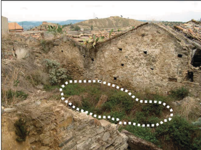
Fig. 3 - Esempio di sinkhole generatosi per piping al di sotto di un fabbricato, ubicato nella parte di monte del centro storico, che ne ha determinato il crollo.
