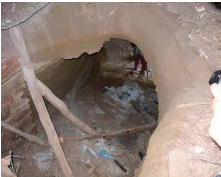
Fig. 4 - Crollo di cavità all'interno di un edificio nel centro storico con fluidificazione del materiale verso cavità con accesso diretto alle ripide scarpate che circondano il sito.
