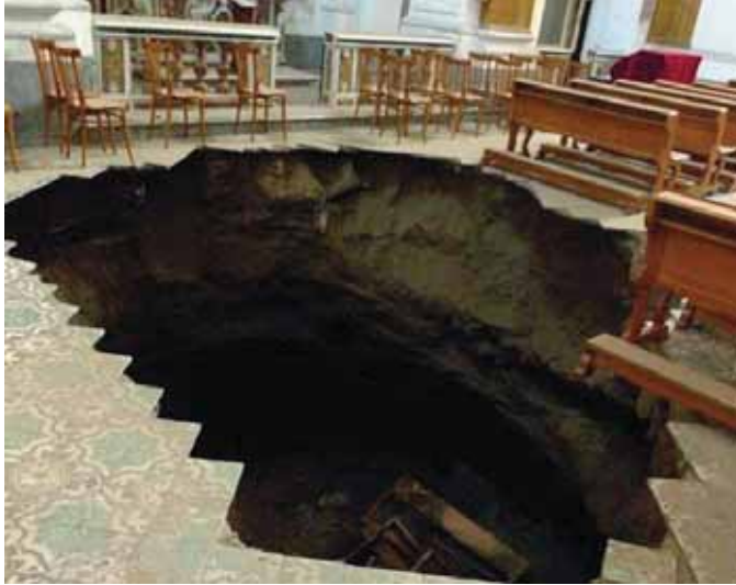
Fig. 10 - Sprofondamenti presso il Vico S. Carlo alle Mortelle, 24 settembre 2009; uno sprofondamento ha coinvolto la chiesa di S. Carlo (foto da www.limatino.it ).
