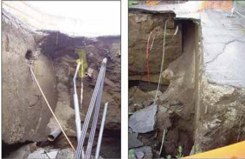
Fig. 9 – Sinkhole a Via Galatea: a sinistra vista delle reti di servizio interrotte dalla voragine; a destra vista della trincea scavata per la messa in opera della fognatura (foto dell'Associazione "Roma Sotterranea").
