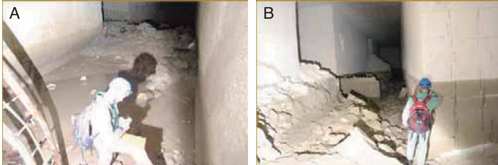
Fig. 6 - a) Ristagno d'acqua sul fondo della galleria; b) evidenze di pregressa sommersione parziale della galleria
