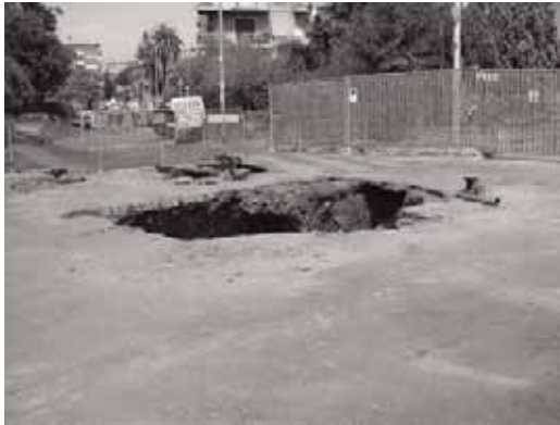
Fig. 2 - Sinkhole con sprofondamento della sede stradale nei pressi di Via Casilina a Roma.
