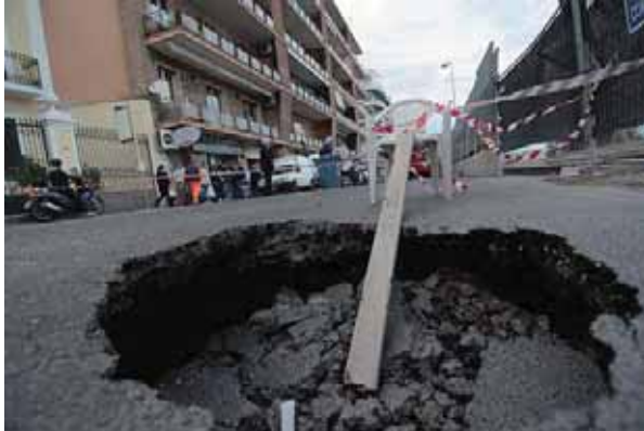
Fig. 8 - Voragine a Napoli presso via Manzoni (foto da www.ilmattino.it ).
