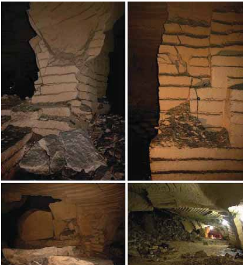
Fig. 10 - Cava di via Firenze a Gallipoli: evidenze di instabilità su pilastri, crolli lungo una parete, vista generale di una delle sale di maggiori dimensioni.
