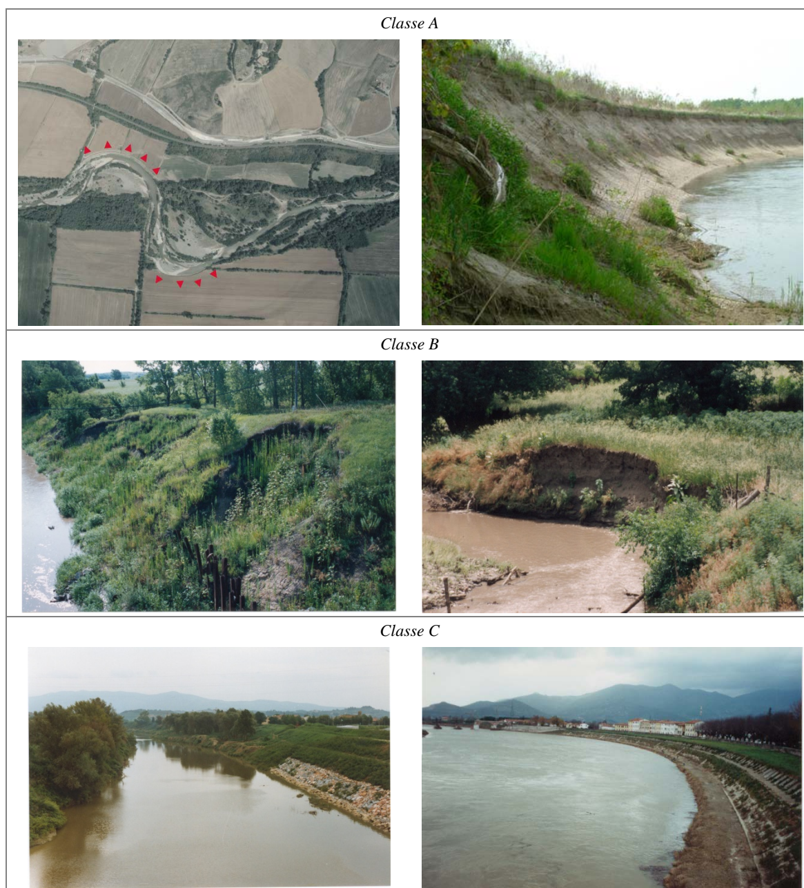
Figura A4.32 – Processi di arretramento delle sponde. Classe A : frequenti sponde in arretramento, soprattutto sul lato esterno delle curve (freccie rosse nella foto a sinistra). Classe B : rientrano in questa classe i tratti con erosioni osservate solo localmente. Classe C : assenza di sponde in erosione per presenza di interventi di protezione e/o dinamica dell'alveo assente.
