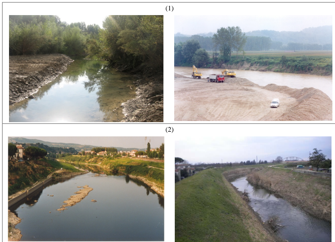
Figura A4.40 – Alterazioni della variabilità della sezione in alvei semi- non confinati. (1) Casi di parziale omogeneizzazione della sezione per interventi di riprofilatura; (2) omogeneità della sezione per tratti estesi a causa di eccessiva artificializzazione.
