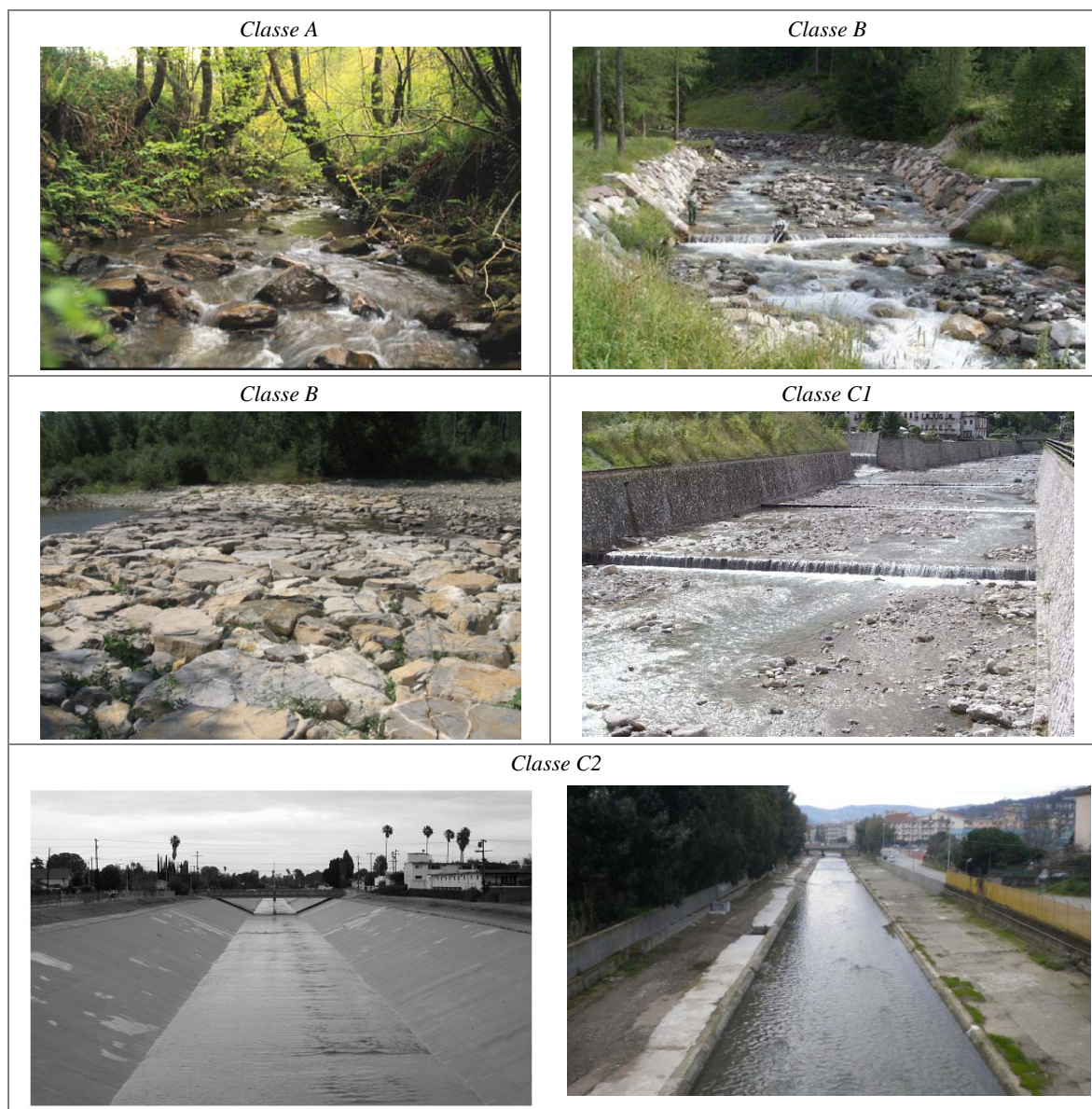
Figura A4.73 – Altre opere di consolidamento e rivestimenti. Classe A : alveo con totale assenza di opere di consolidamento o rivestimento del fondo. Classe B : presenza di soglie (prima riga a destra) o di rampe in massi (seconda riga a sinistra) con bassa densità. Classe C1 : presenza di numerose soglie e parziale rivestimento del fondo. Classe C2 : totale rivestimento del fondo con tipologia impermeabile. Nel caso tale rivestimento interessa gran parte del tratto (> 80%), si assegna una penalità aggiuntiva di 12 .
