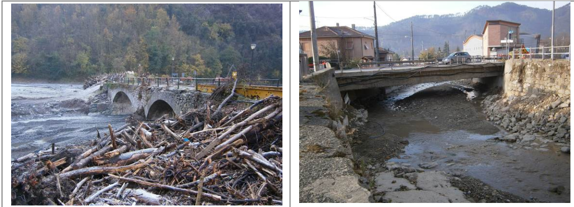
Figura A7.11 – Ponti del tipo 1: a sinistra, ad arcate con una pila in alveo. Sulle sponde si vede il materiale legnoso che lo aveva ostruito completamente; a destra, a campata unica, con sia altezza che larghezza insufficienti.
