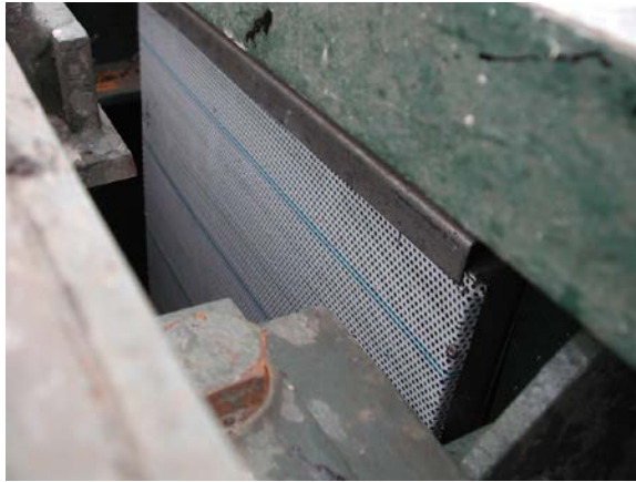
Pannelli fono assorbenti sul ponte di Pisa.
