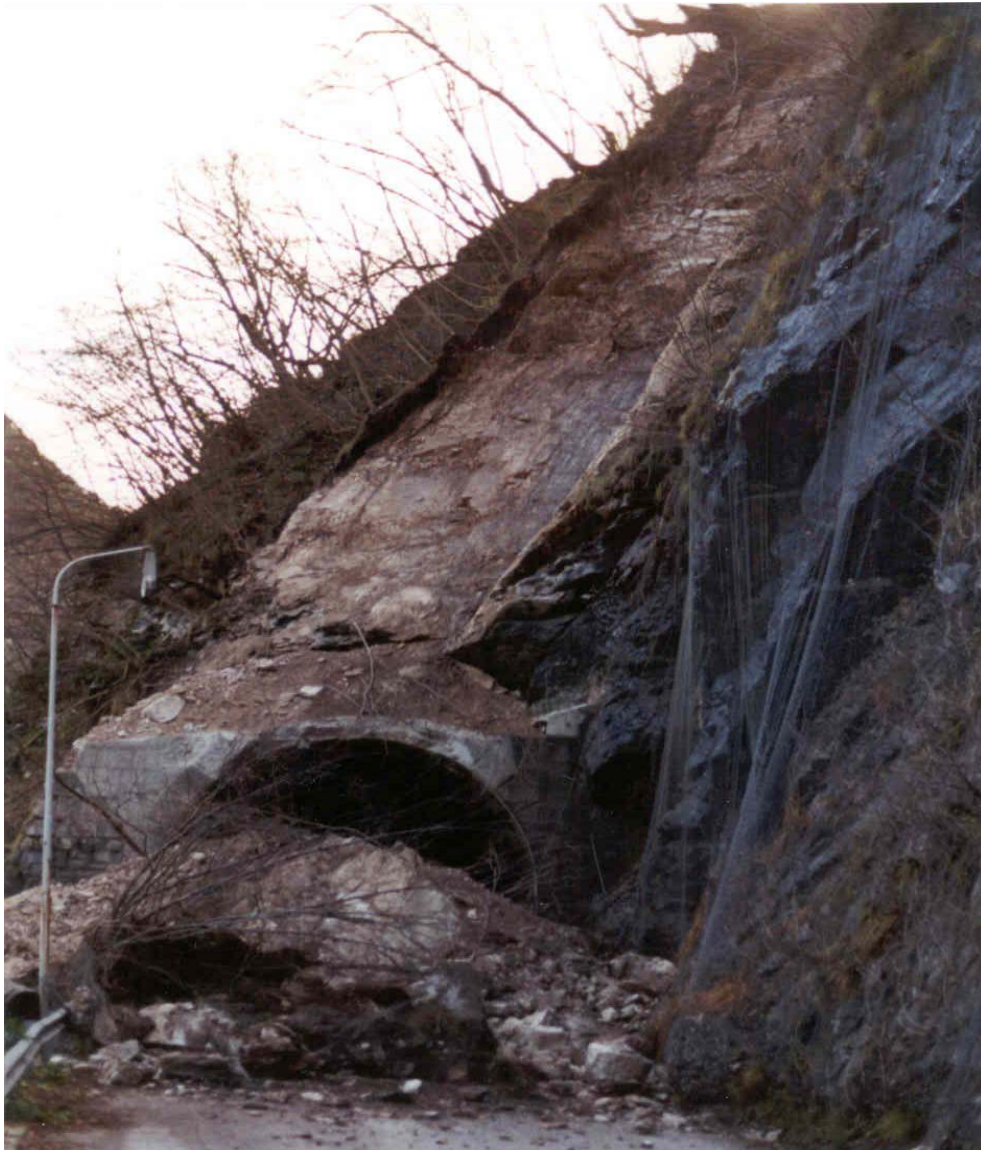
Figura 11.18 Area soggetta a crolli/ribaltamenti diffusi n. 0300330200 in Comune di Dogna (Udine). Particolare del cedimento di un diedro roccioso in corrispondenza dell'imbocco di una galleria stradale.
