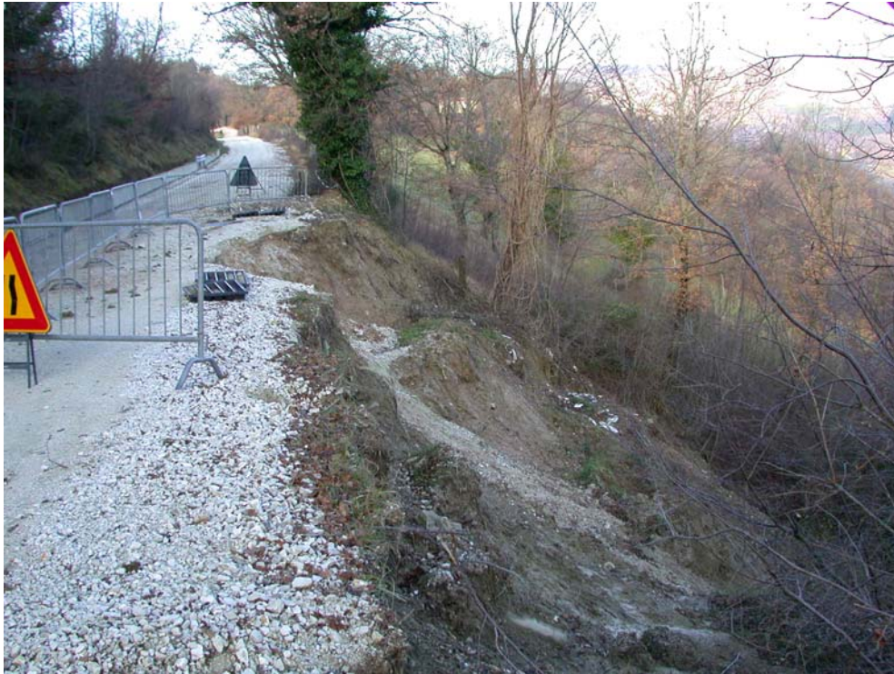
Figura 15.39 Evento meteorologico novembre 2005 - Frana di scivolamento con interruzione della strada comunale di S. Cristina nel comune di Valtopina (PG).
