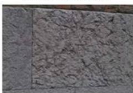
Chiesa del SS Sacramento: erosione dei paramenti
