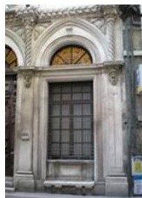
Loggia dei Mercanti: depositi superficiali
