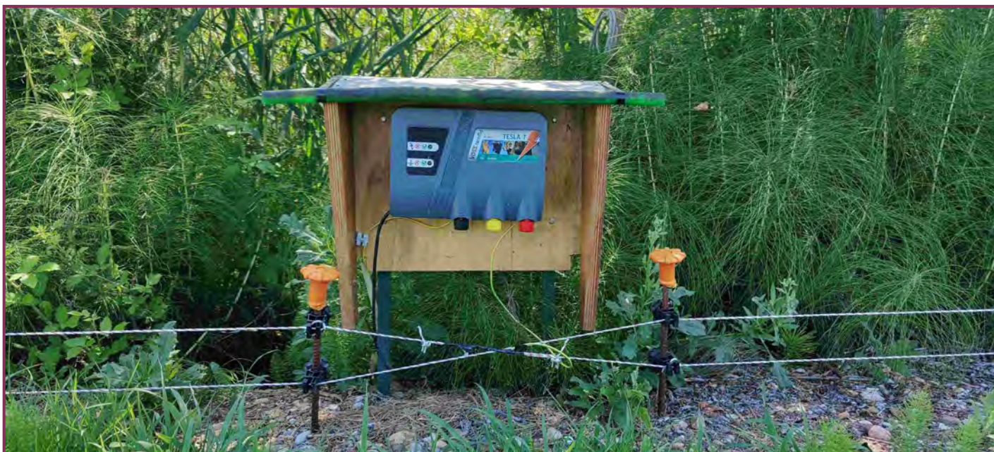
Figura 4. Il trasformatore del circuito elettrico protetto da una piccola tettoia (foto di A. Riviera).
